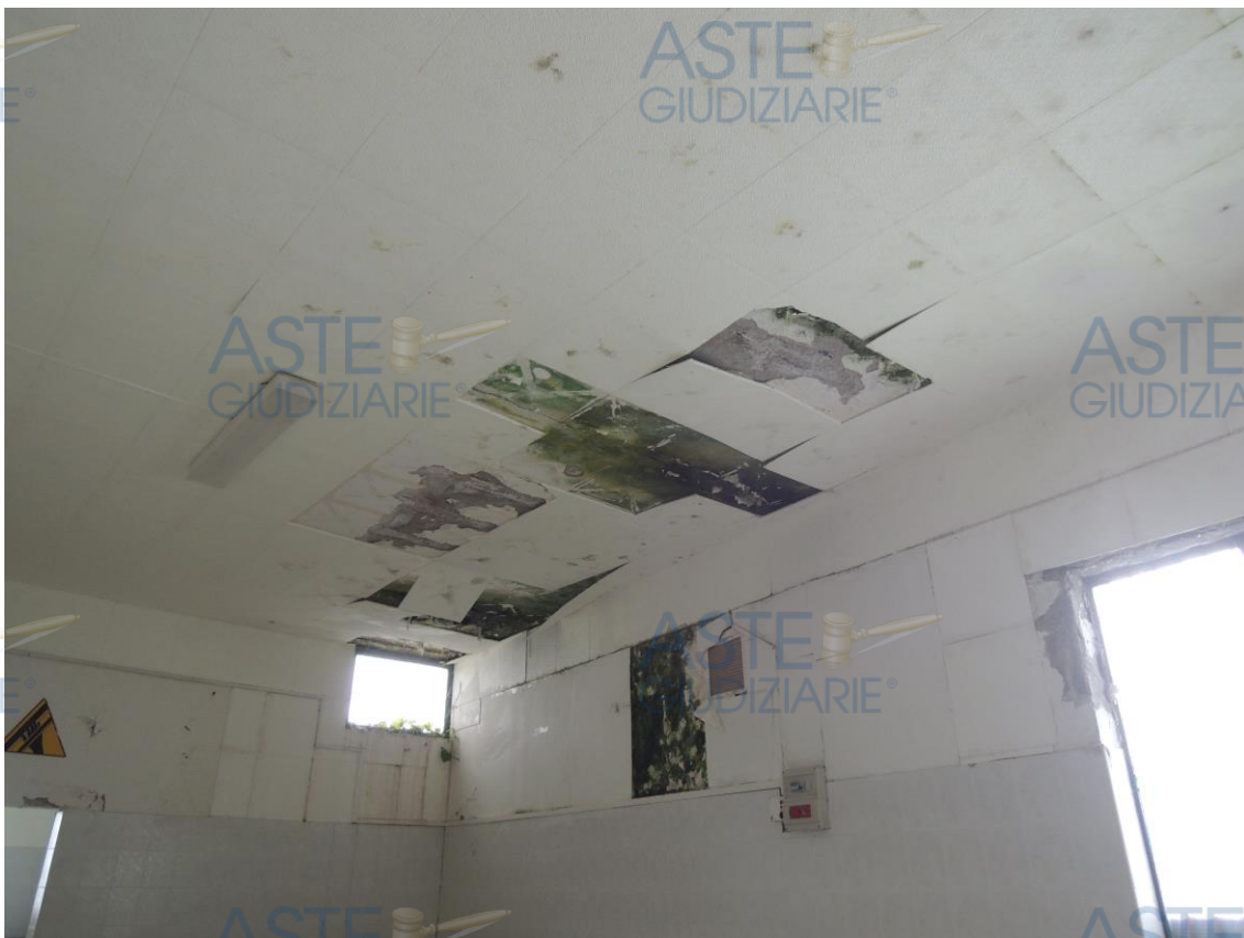
Figura 2 _particolare infiltrazione locale piano terra
