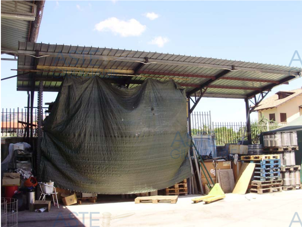
Foto n. 11 – tettoia abusiva costruita sulla corte del fabbricato
