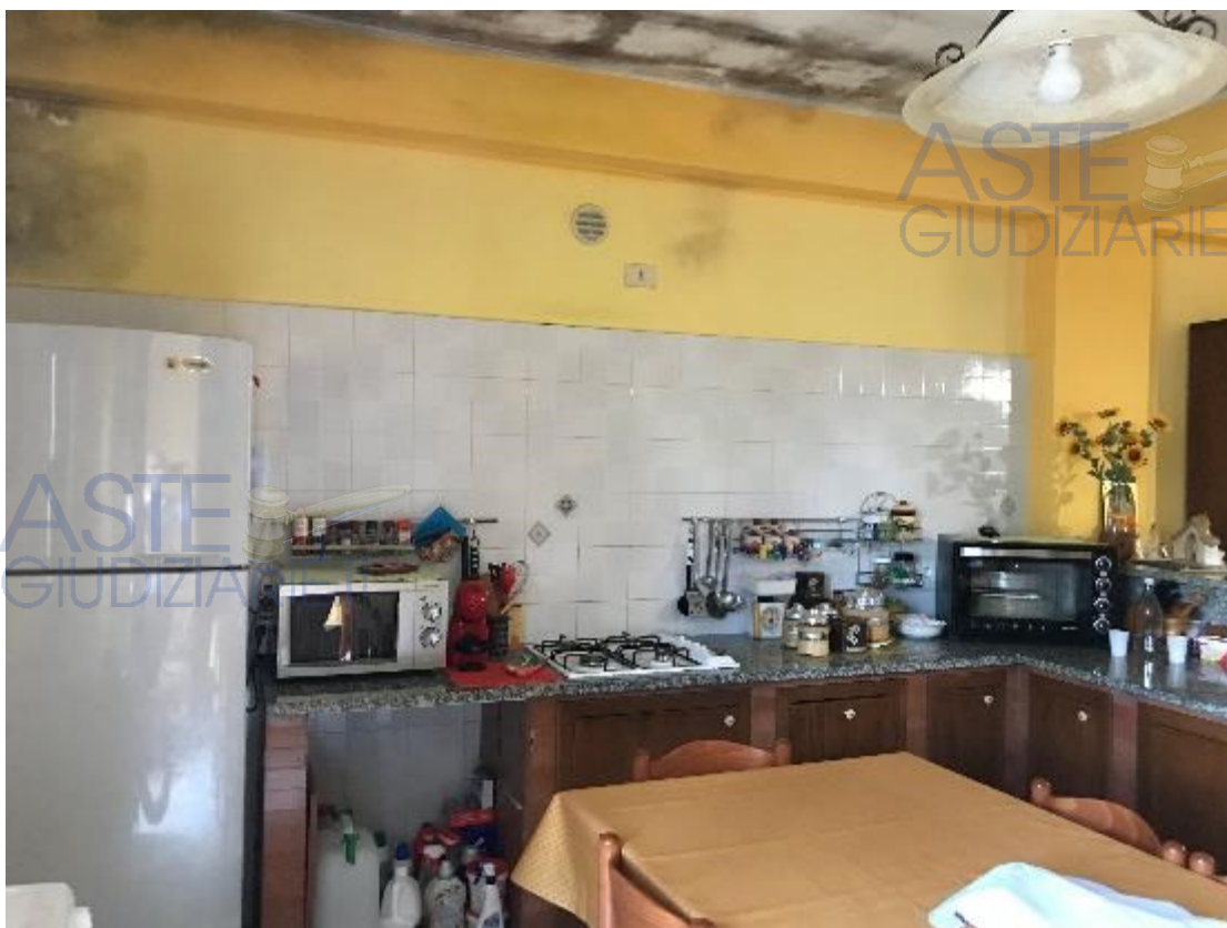
Foto 1.12 – Particolare della cucina
