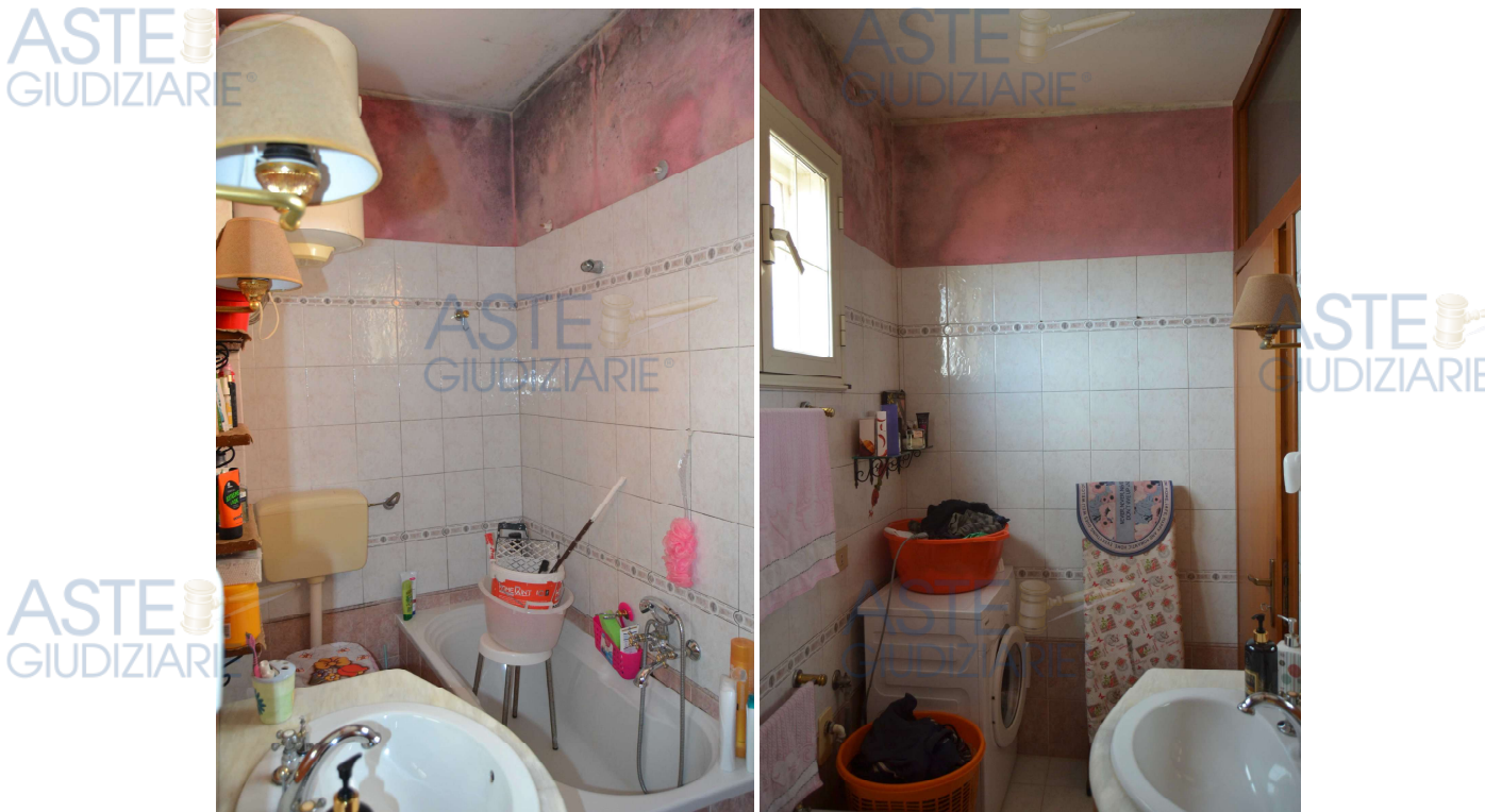
Figura 13 – servizio igienico – in dettaglio evidente tracce di umidità da infiltrazione e da condensa
