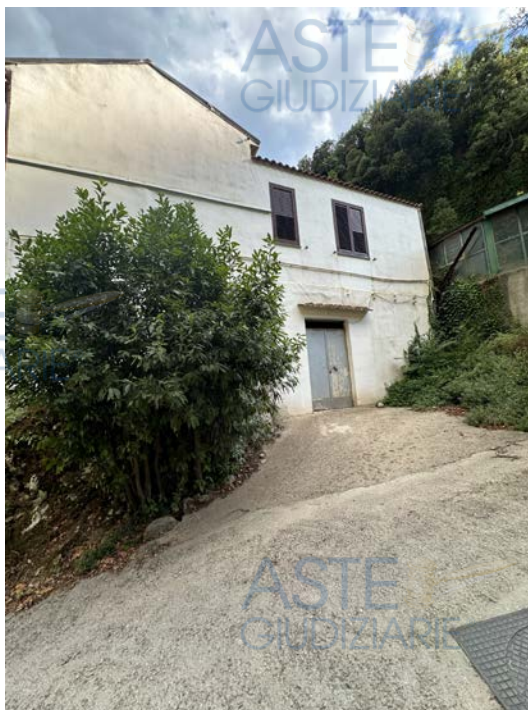
Foto 42: Vista del prospetto laterale della casa del custode (si nota l'ingresso al deposito posto al piano terra)
