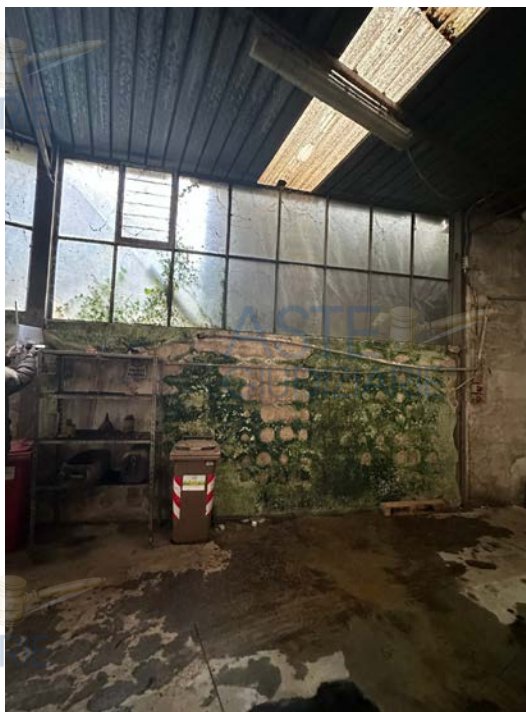
Foto 52: Particolare dello stato di degrado del primo corpo di fabbrica
