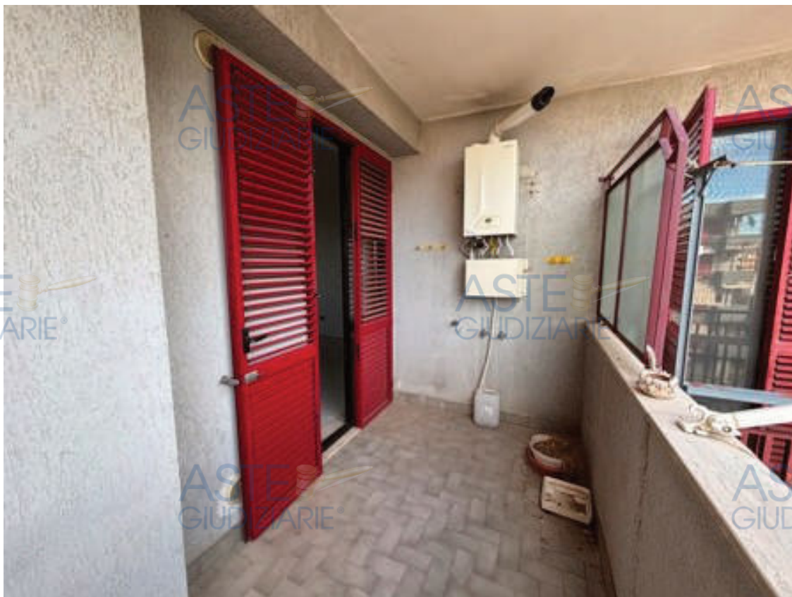
Foto 15 – 10/10/2025 – Balcone con caldaia a condensazione
