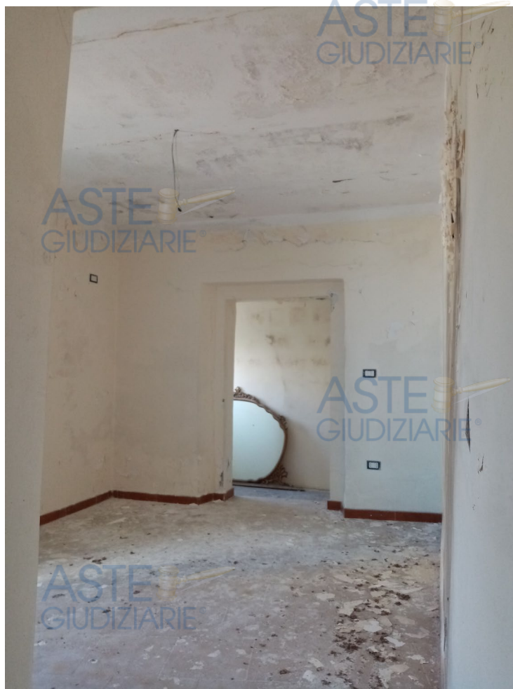
FOTO 9: vano camera con varco di accesso all'area balcone, abusivamente ampliata con chiusura in muratura.
