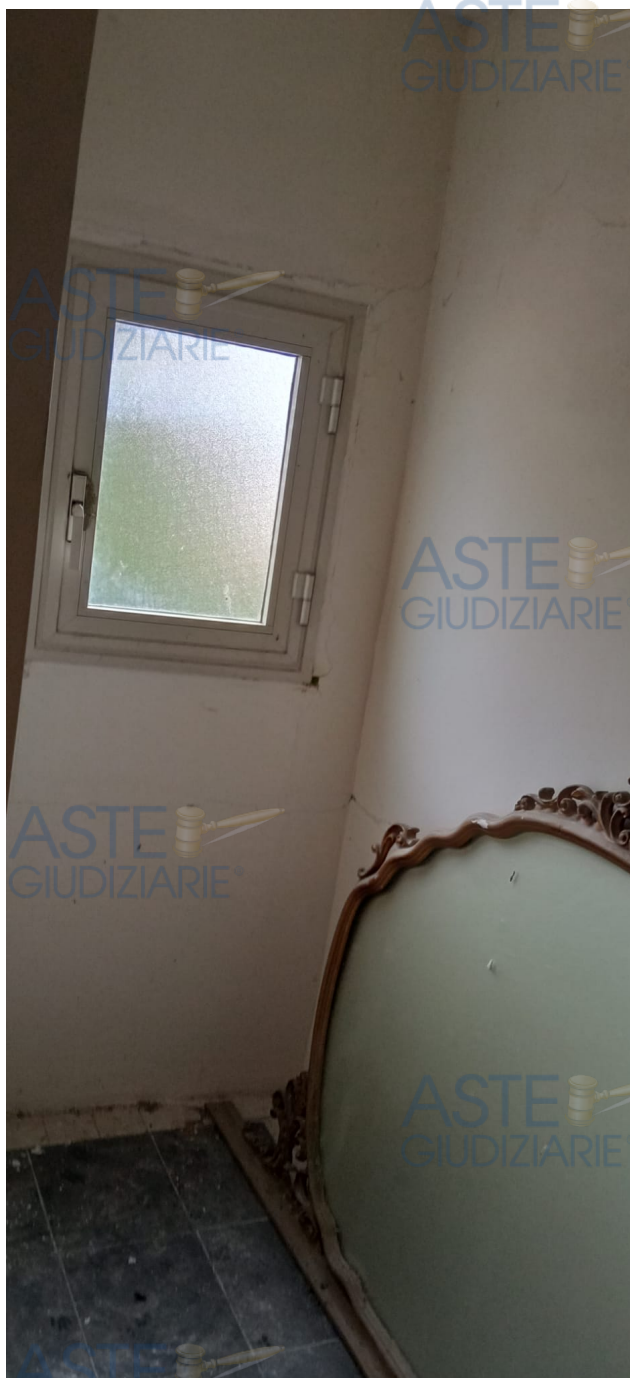
FOTO 13: ampliamento abusivo balcone
