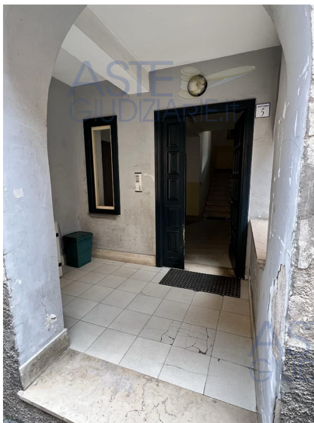
Foto 5 – Portone comune di accesso al fabbricato dal portico condominiale. Si notino le finiture in mediocre stato di conservazione.
