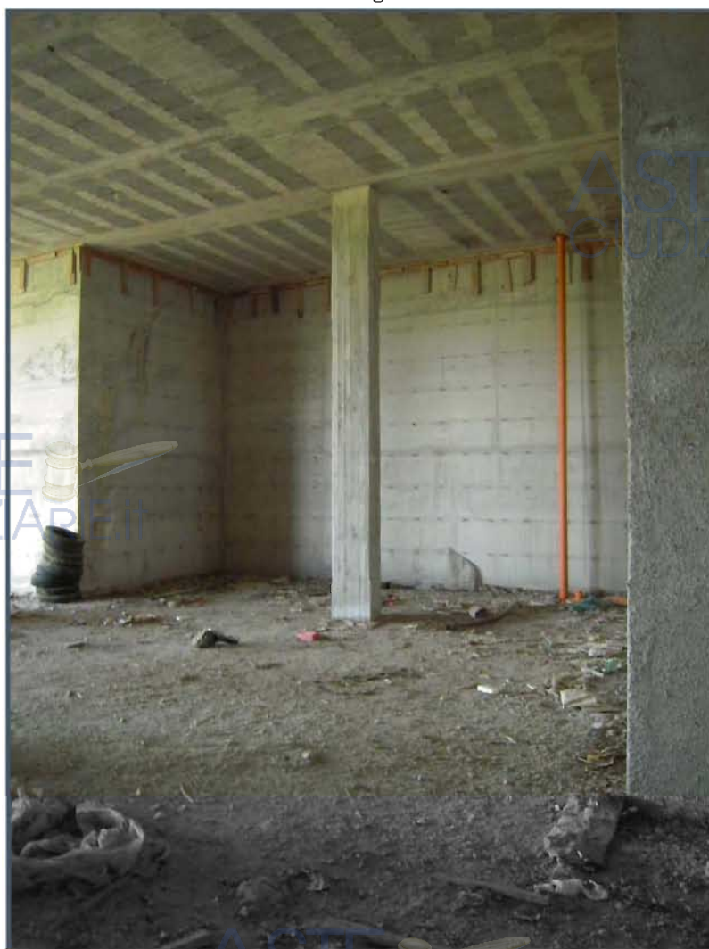
Foto 14 INTERNI SUB. 4 (deposito superiore): piccola Porzione Nord Est del vano deposito fuori sagoma e difforme dai grafici assentiti presso l'U.T.C. di Serre, quand'anche non oggetto di contestazioni di regolarità allo stato attuale.
