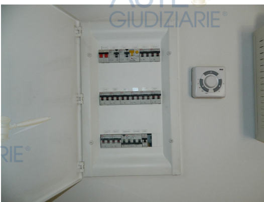
Figura 6- quadro elettrico posto nell'appartamento sub.18
