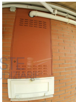
Figura 7- caldaia posta nell'appartamento sub.17
