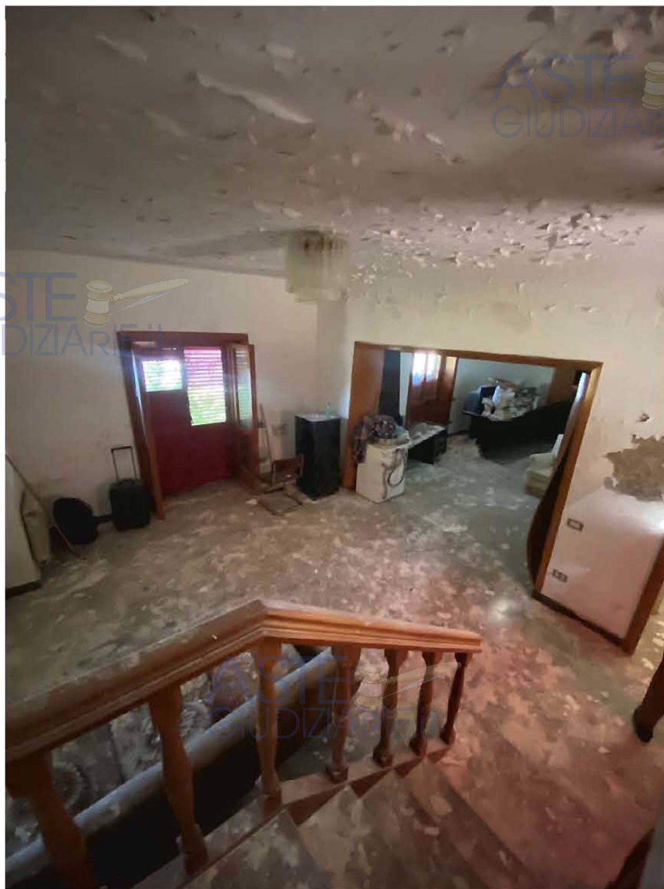
Foto degli interni dell'abitazione, con in evidenza alcune finiture ormai danneggiate, e l'esfoliazione della pittura causata da probabile umidità
