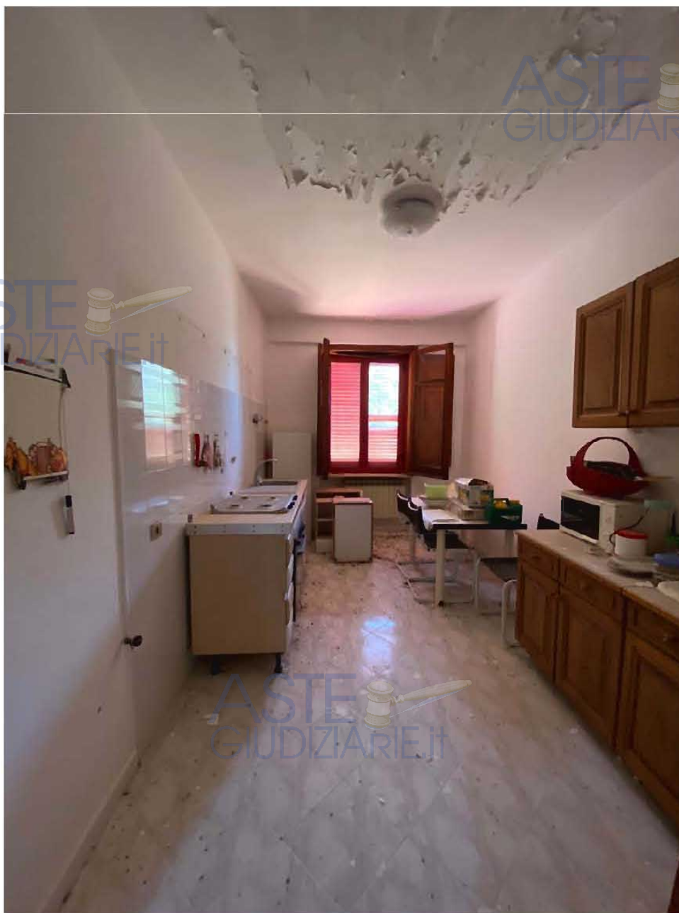
Foto degli interni dell'abitazione, con in evidenza alcune finiture ormai invecchiate e in parte danneggiate, e l'esfoliazione della pittura causata da probabile umidità
