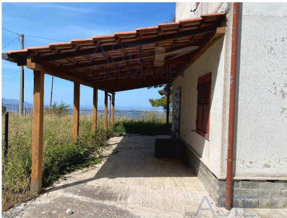
Foto degli esterni dell'abitazione lotto Unico, con in primo piano la tettoia di piano terra anch'essa di dubbia legittimità edilizia e cautelativamente detratta dalla valutazione finale del cespite nel suo complesso
