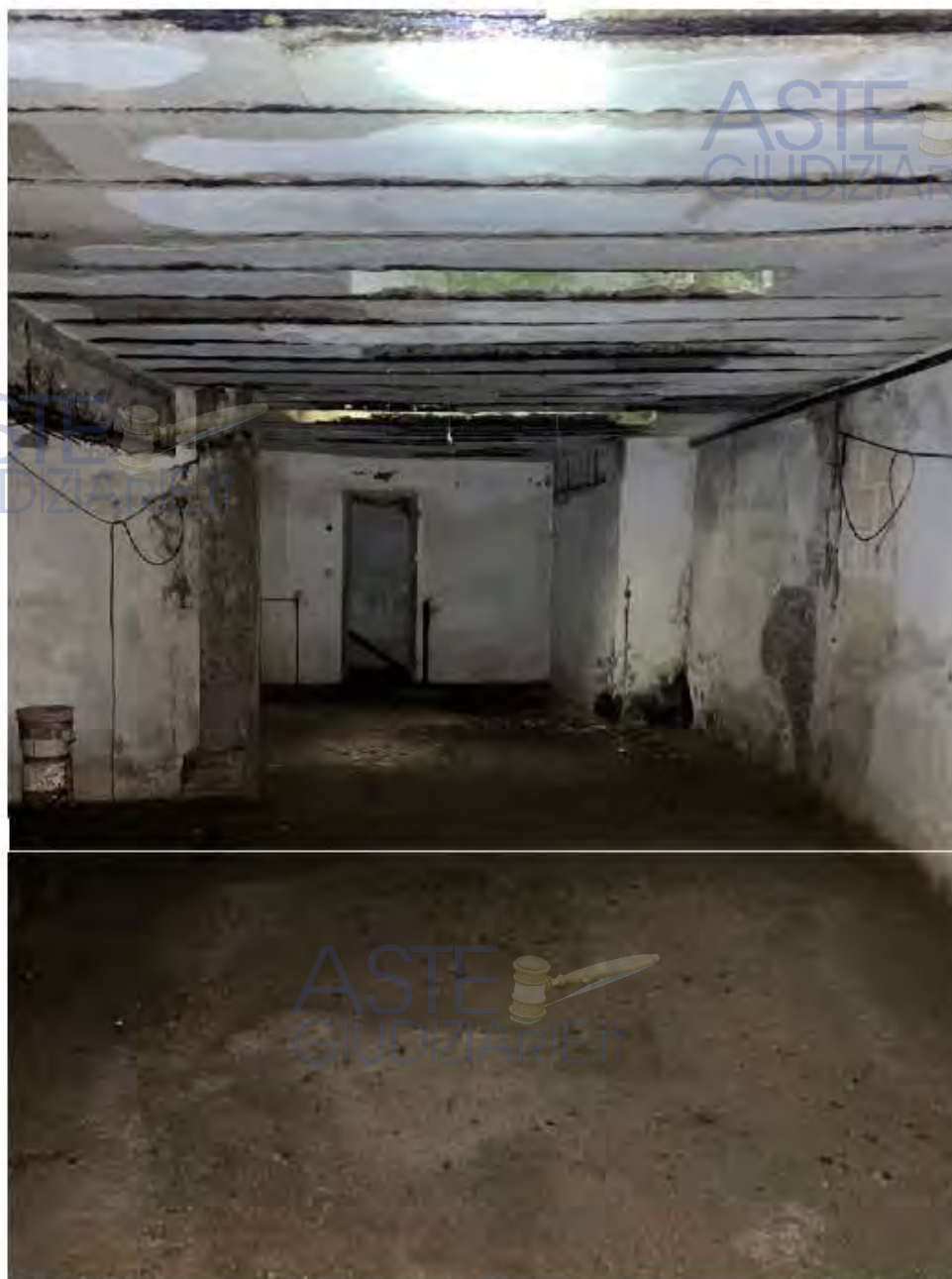
Particolare del solaio della zona retrostante del cespite (sormontata da un ampio terrazzo/Vanella), affetto da un inizio di avvallamento oltre che dai diffusi problemi di degrado strutturale e delle finiture già ampiamente descritto in precedenza
