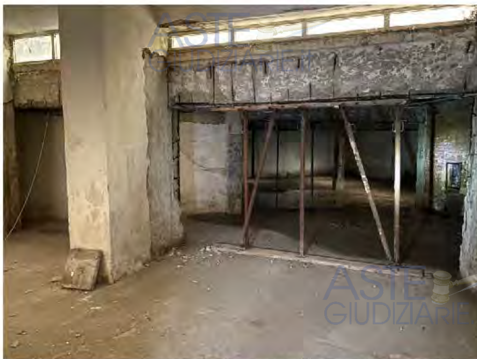
Foto della zona di transizione tra la parte antistante e quella retrostante del cespite, nella stessa è particolarmente evidente come alcuni elementi costituenti la struttura portante (peraltro sormontata in tale zona da diverse unità immobiliari ad uso abitativo), siano danneggiati in maniera estremamente avanzata, e meritevoli di NECESSARIO intervento.
