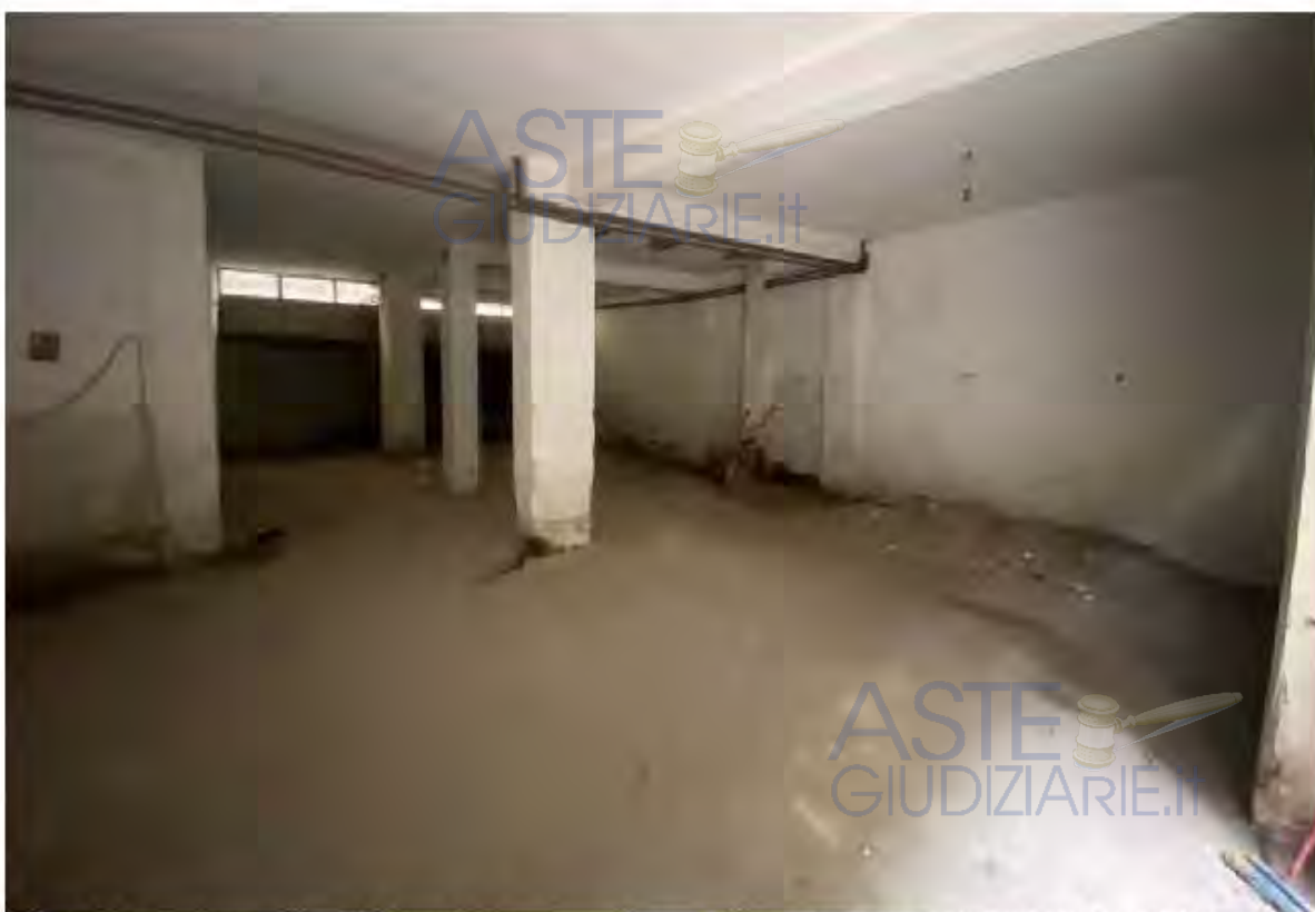
Vista di insieme della porzione antistante del cespite la quale risulta essere l'unica a presentarsi in condizioni accettabili, seppur in mediocre stato di conservazione e meritevole di dovuti ripristini;
