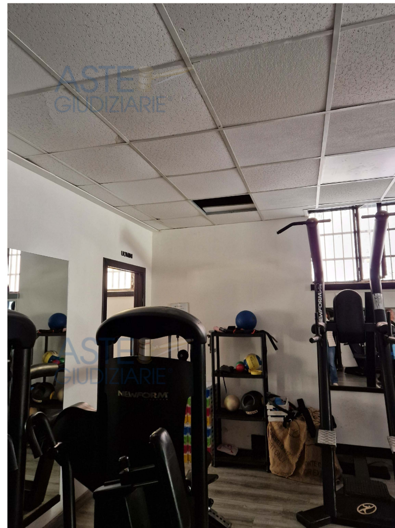
Foto 2: Sala attrezzi – pannello rimosso per ispezione visiva
