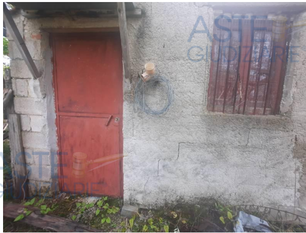
FOTO 15: Porta di accesso al comparto deposito dell'annesso agricolo, con serratura funzionante.
