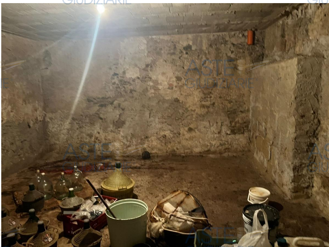
Foto 31 – Piano seminterrato, ulteriore vano adibito a cantina. Si noti il pessimo stato di conservazione e manutenzione.
