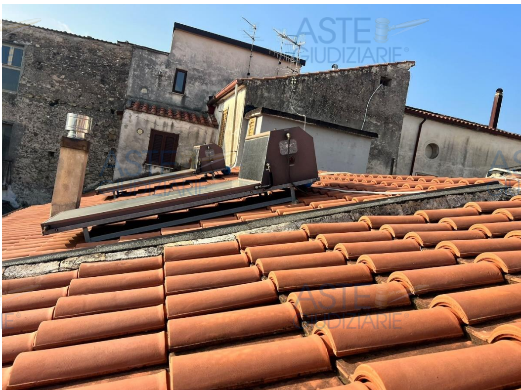
Foto 28 – Impianto solare termico posto sulla copertura a falde.
