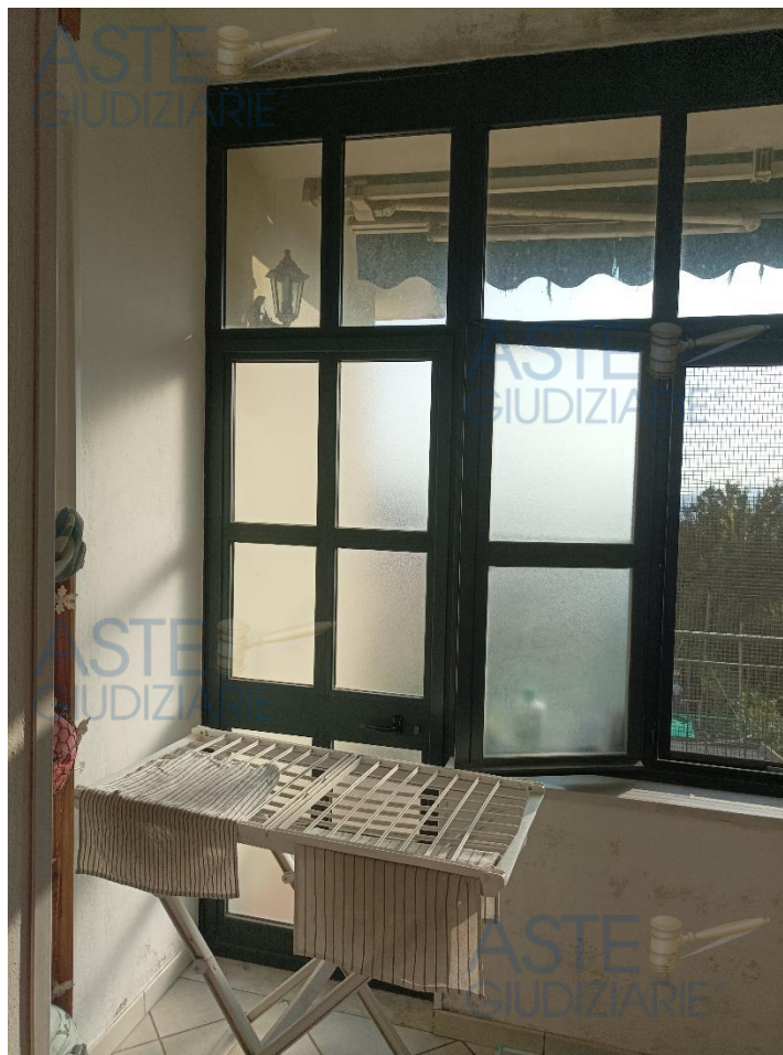
Foto 17 – Veranda, collegata all'ambiente cucina. Si notino le infiltrazioni d'acqua sul soffitto . Dalla veranda si accede al terrazzino a livello.
