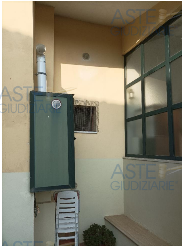
Foto 20 – Sul terrazzino a livello è installata una caldaia.
