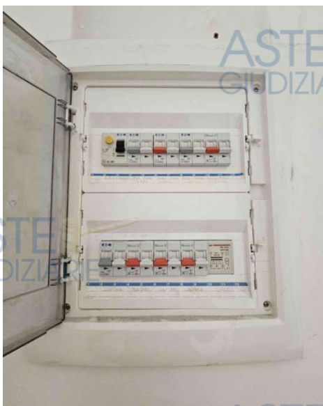
Quadro elettrico - foto 26
