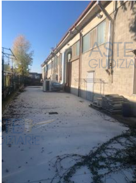
Vista Capannone di Via Vecchia Novi (fonte: Foto): presenza impianto di aerazione attualmente in disuso
