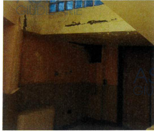
Infiltrazioni di umidità
