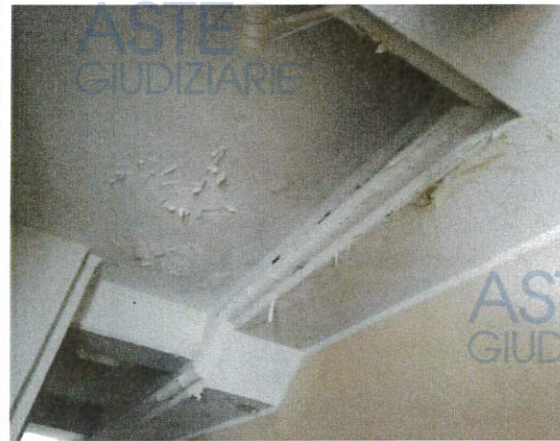
Infiltrazioni di umidità
