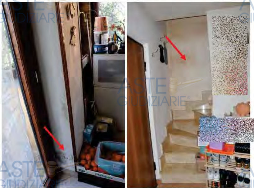
Macchie di umidità
