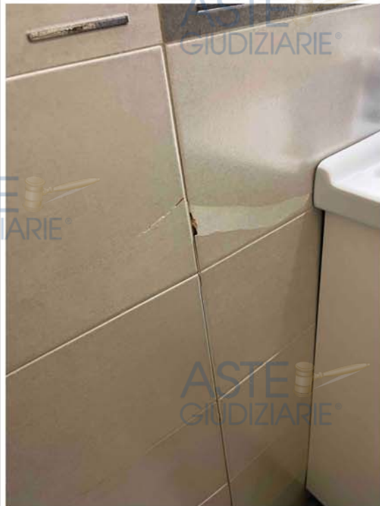
foto 13 – rivestimento del bagno danneggiato
