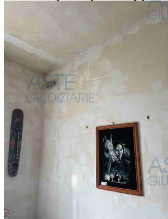
foto 10 – pareti e soffitto del soggiorno danneggiati
