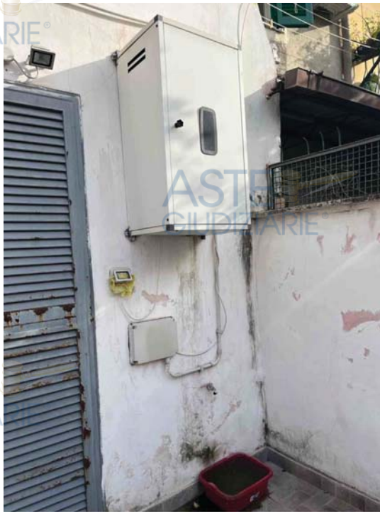
foto 19 – box caldaia nella corte esclusiva
