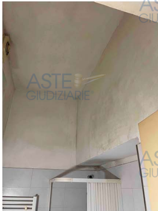
foto 14 – condensa a parete nel bagno cieco
