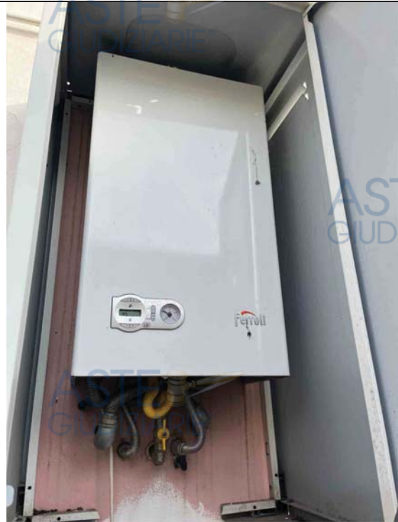
foto 20 – caldaia a gas marca Ferrol
