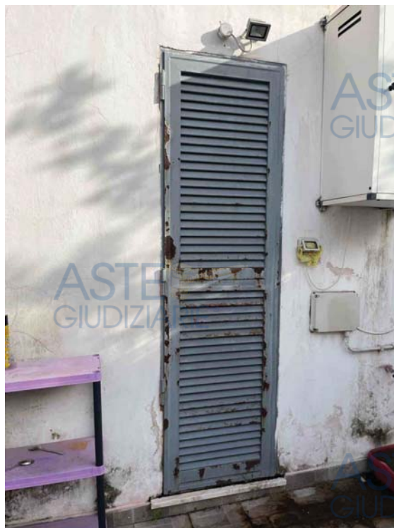
foto 18 – persiana in ferro della camera da letto deteriorata
