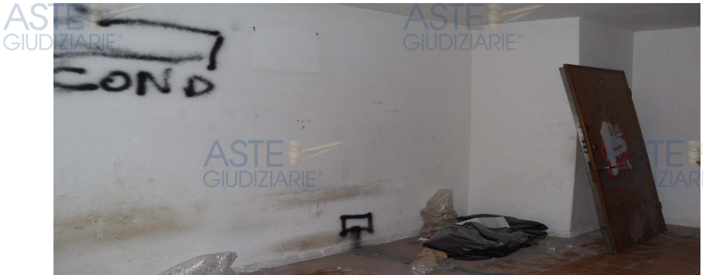
(CAMERA - INTERVENTI DI RISTRUTTURAZIONE NON ULTIMATI)
