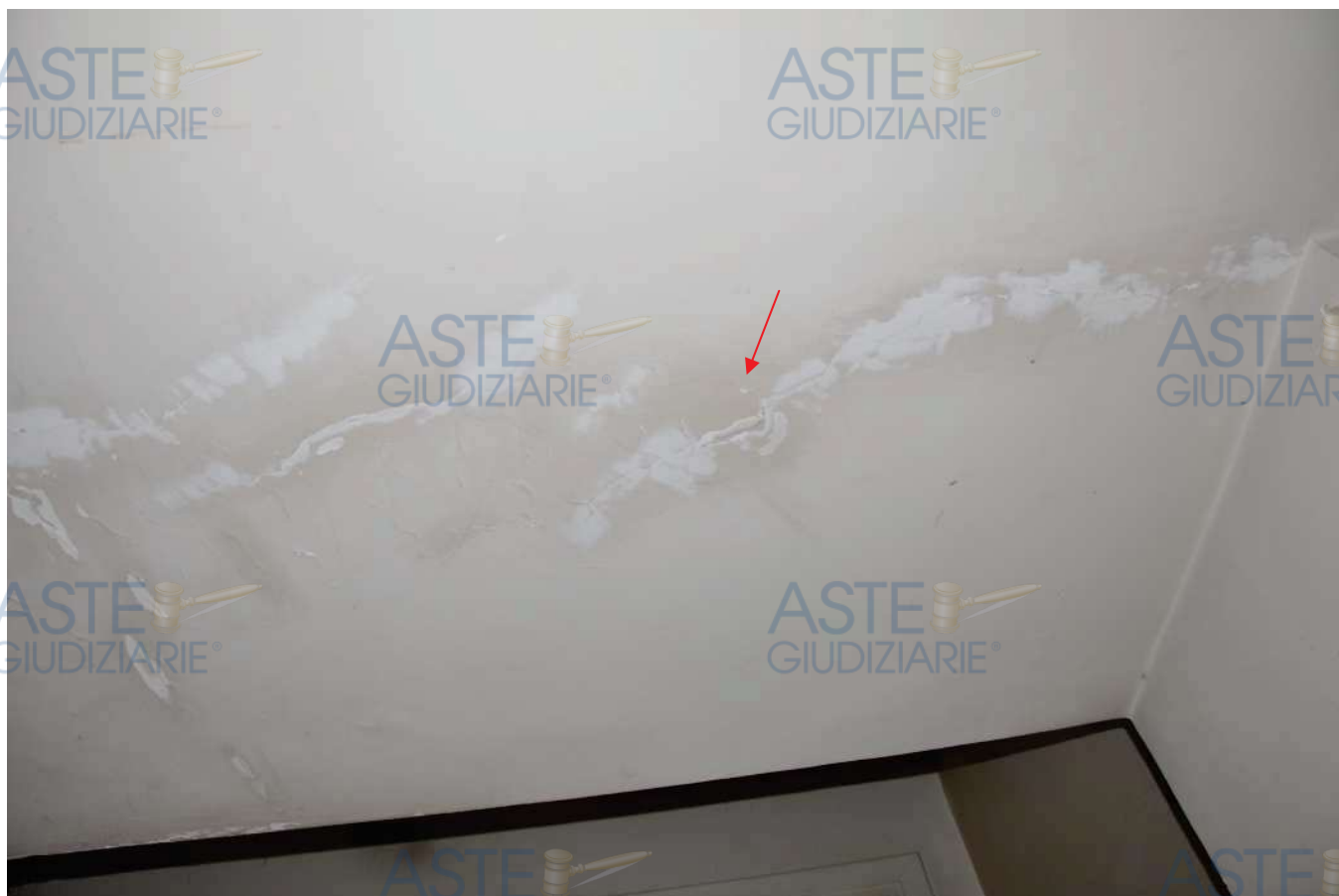
Fessurazioni nel muro
