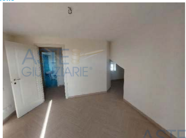
Il locale tecnico
