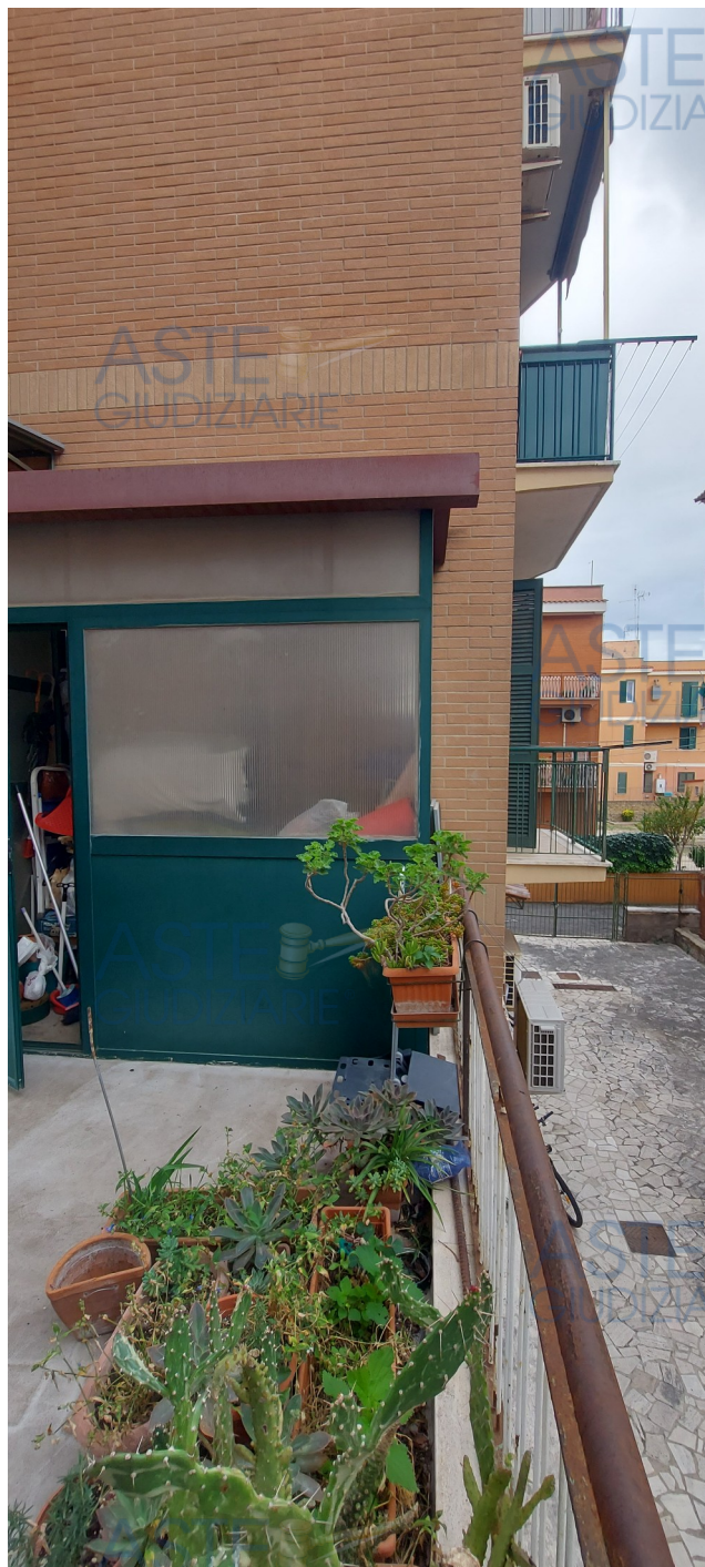
Situazione attuale - Piano primo (rialzato). In primo piano parapetto metallico (in secondo piano il nuovo volume - deposito).
