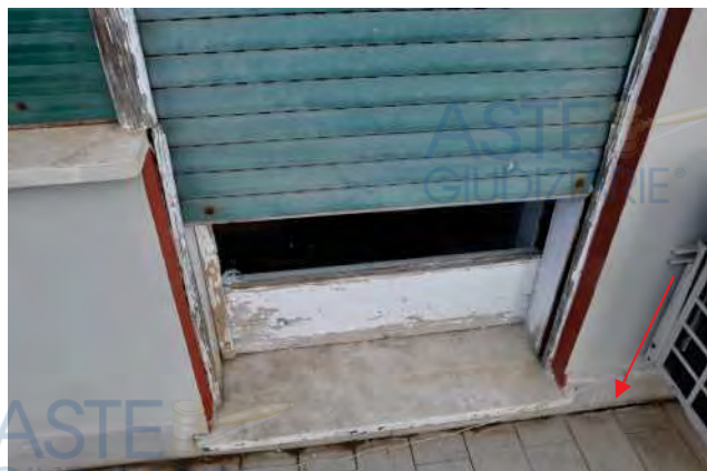
Infiltrazioni dal terrazzo
