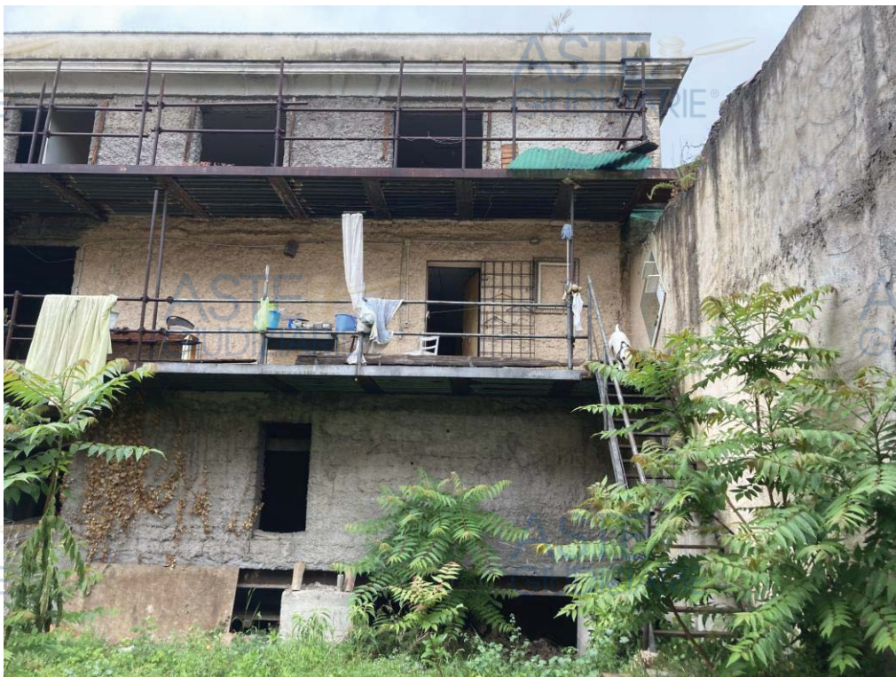
i balconi a sbalzo nell'edificio A, al piano primo e al piano secondo, per i quali non è stato reperito titolo abilitativo
