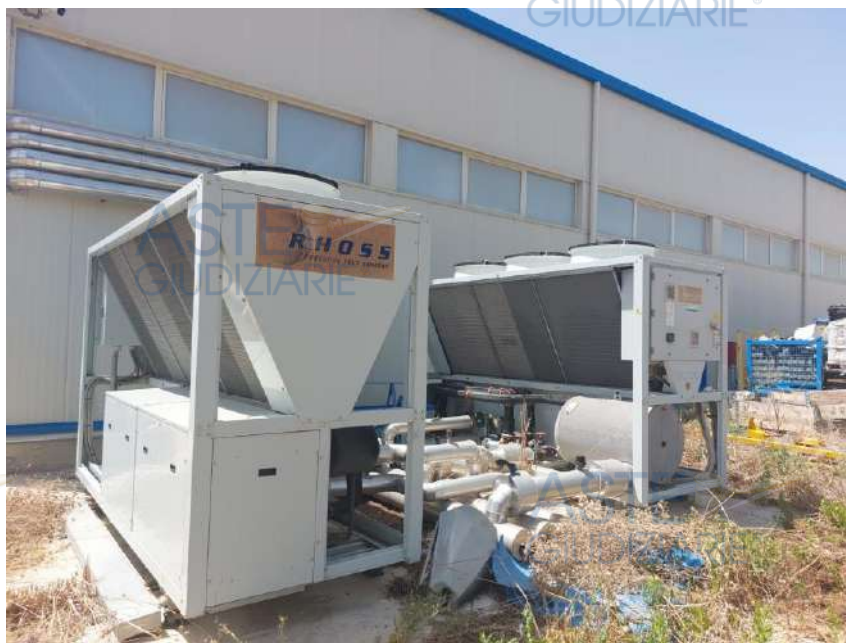
Figura 13. Macchina impianto riscaldamento/raffrescamento a servizio del "Capannone 5"
