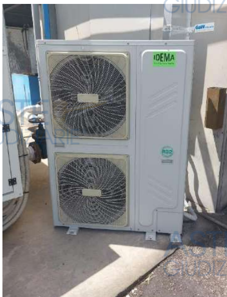
Figura 7. Macchina impianto riscaldamento/raffrescamento a servizio della zona uffici a servizio del "Capannone opificio"
