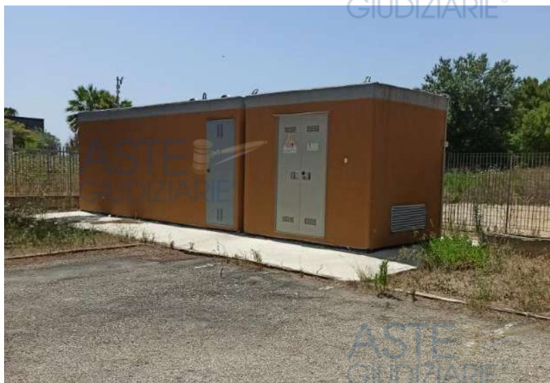
Figura 15. Locali elettrici non accatastati
