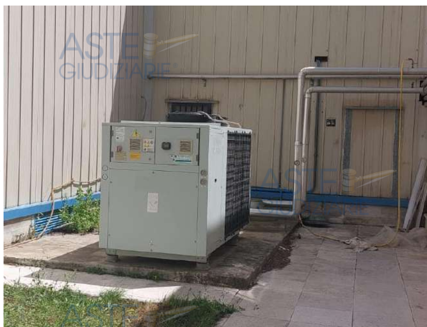
Figura 9. Macchine impianto di riscaldamento/raffrescamento a servizio della Palazzina Uffici
