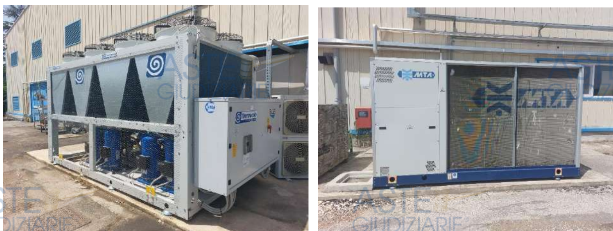
Figura 6. Macchine impianto di riscaldamento/raffrescamento a servizio del "Capannone Opificio" – zona produzione
