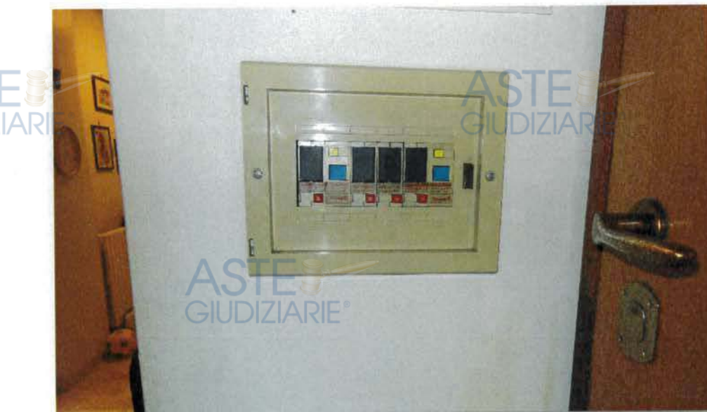
FOTO 08 VISTA PARTICOLARE QUADRO ELETTRICO
