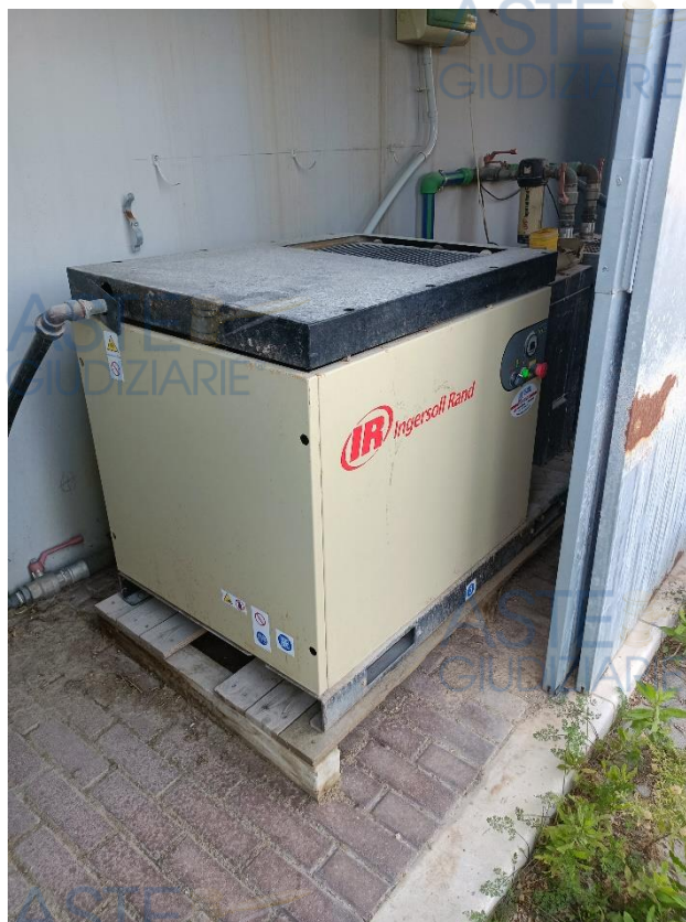
Foto n. 19 – COMPRESSORE INRI5K AIR SERVICE
