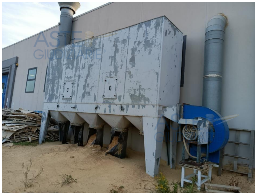
Foto n. 26 - FILTRO A MANICHE MOD.SCC. 5/20 C-S
