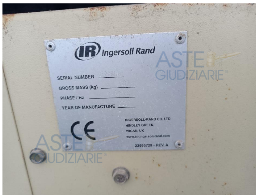
Foto n. 20 - COMPRESSORE INRI5K AIR SERVICE
