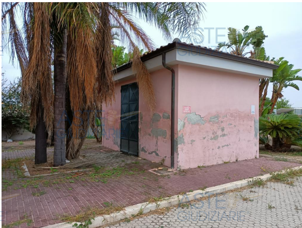
Foto n. 57 – Corpo G – Locale pompe.
