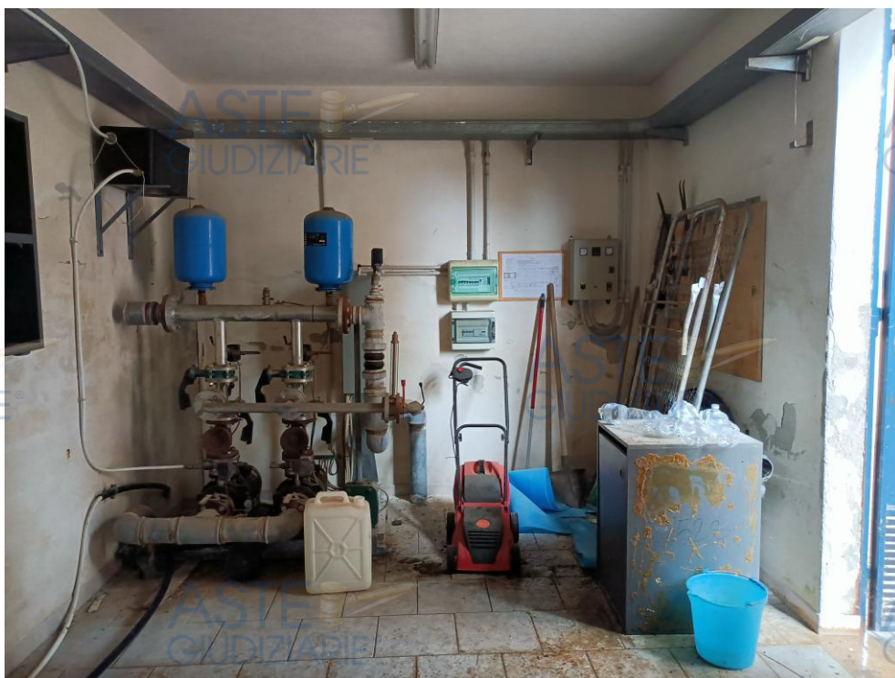
Foto n. 58 – Corpo G – Locale pompe.
