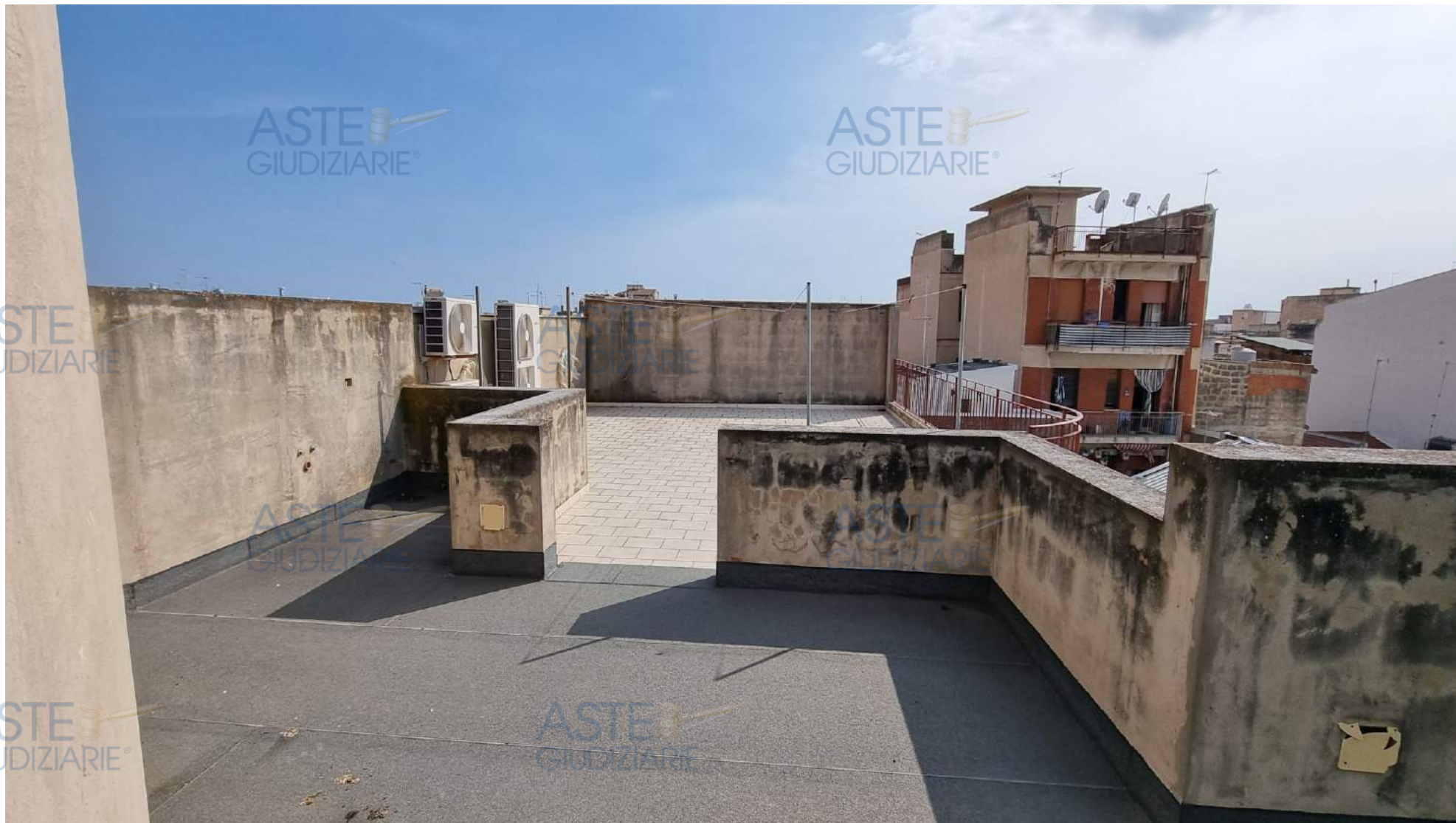
Foto n. 28 - Ragusa, foglio 264 - Fabbricato diruto
