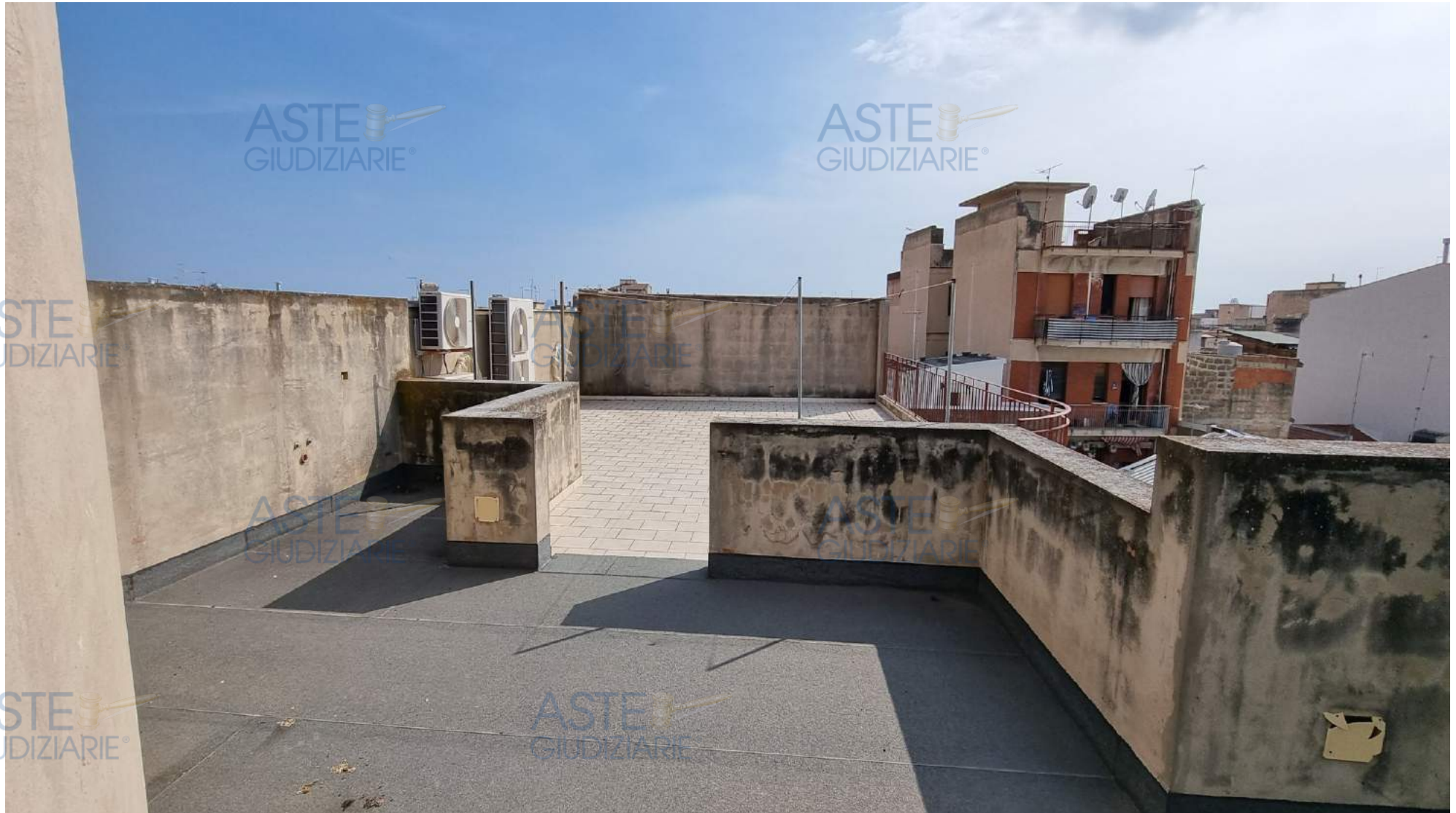
Foto n. 28 - Ragusa, foglio 264 - Fabbricato diruto
