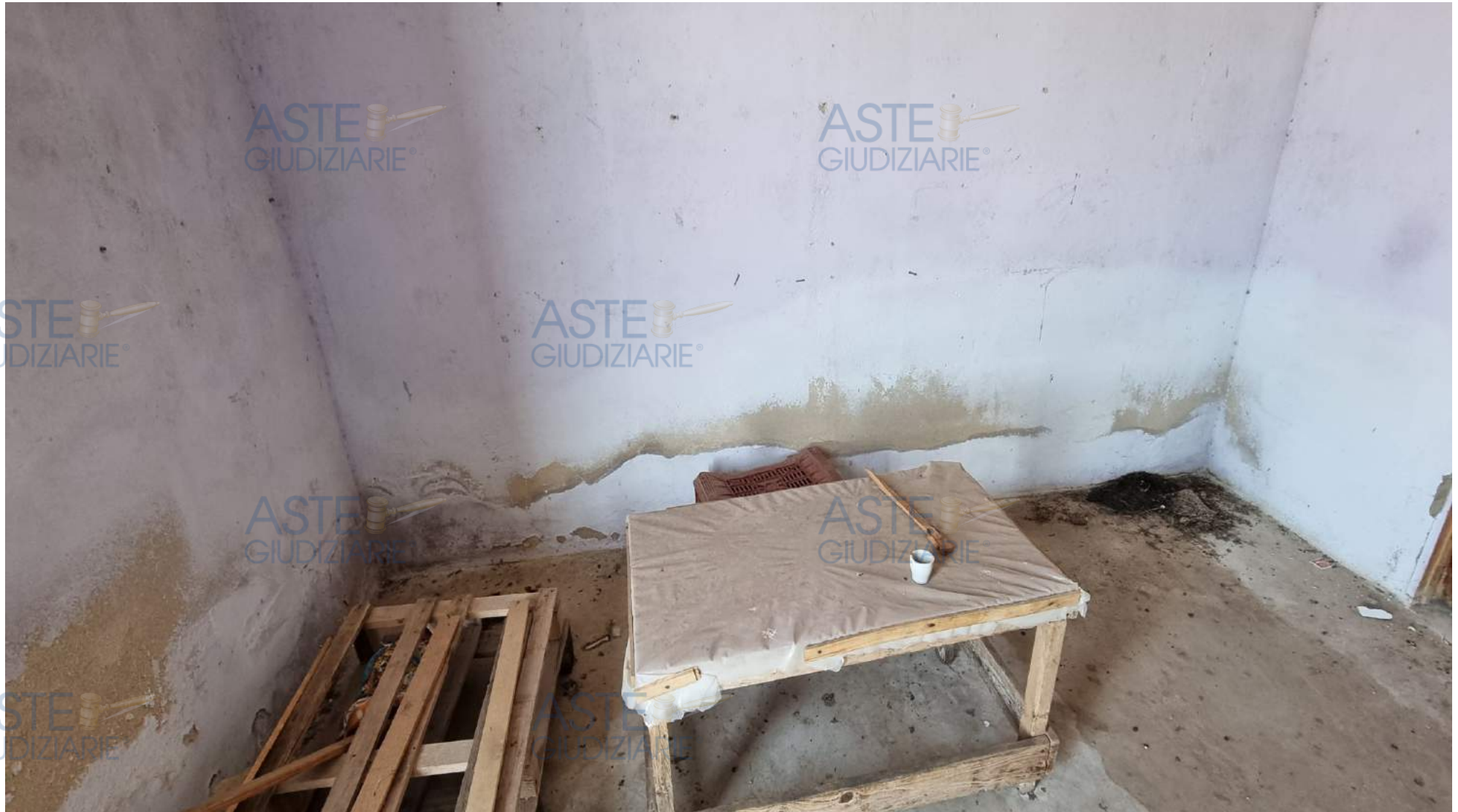
Foto n. 10 - Locale interno al fabbricato di cui sopra. Si notino gli intonaci scrostati e l'umidità di risalita
