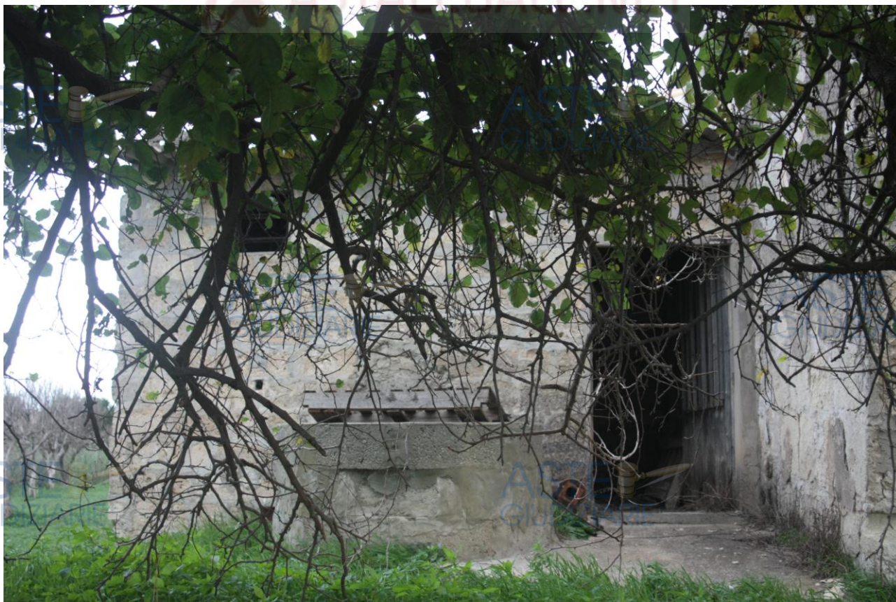
Cespite 2: Locale macchine e pozzo per attingimento in primo piano. all'interno della p.lla 929
