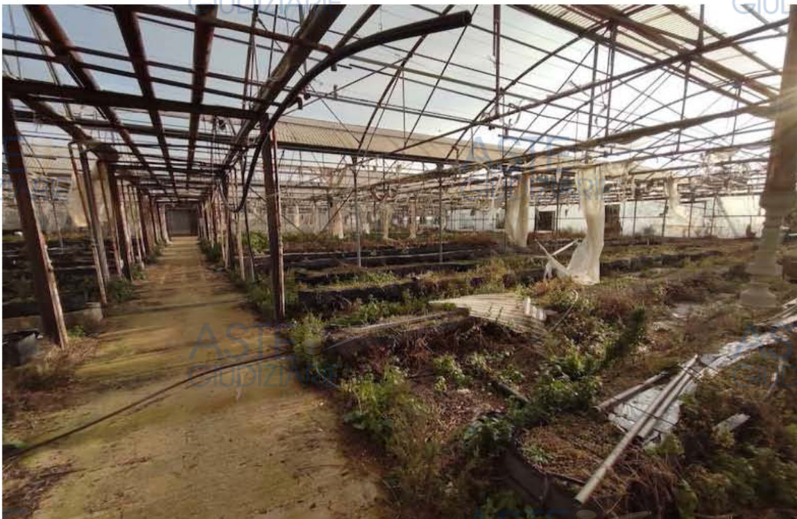
Foto 31 – Lotto 2 – Interno serra 1 in stato di abbandono
