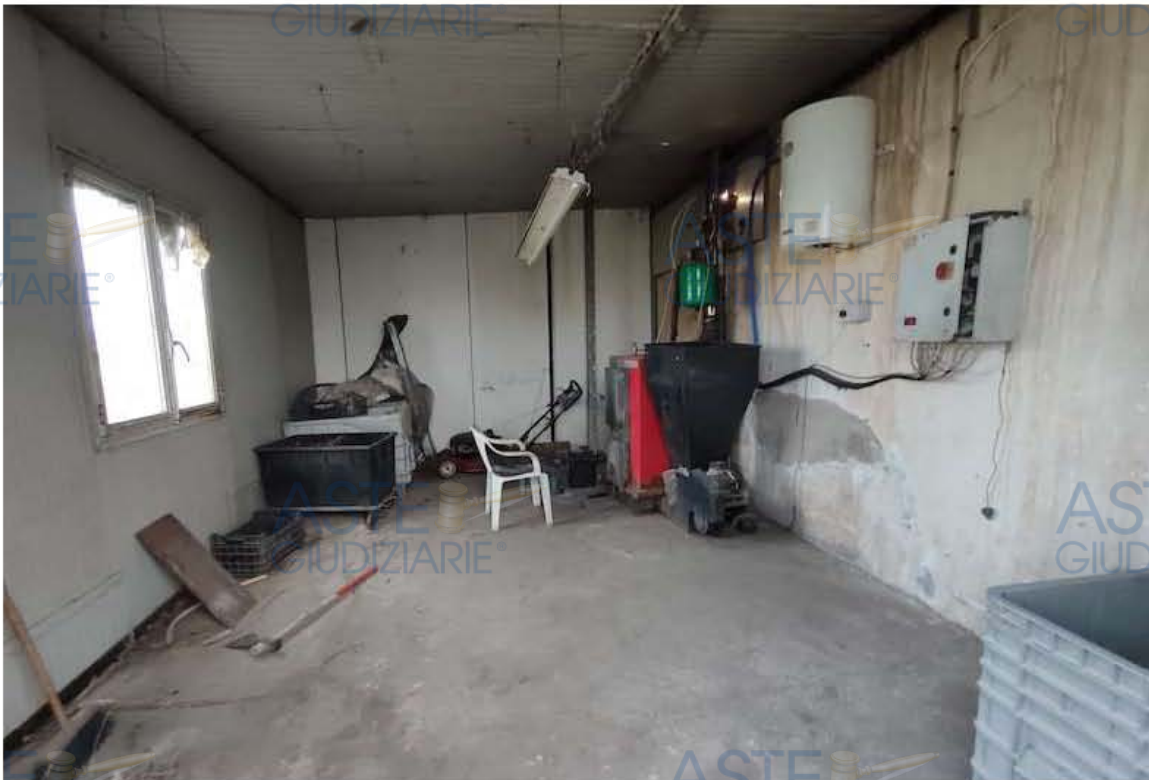
Foto 27 – Lotto 2 – Interno locale caldaia A
