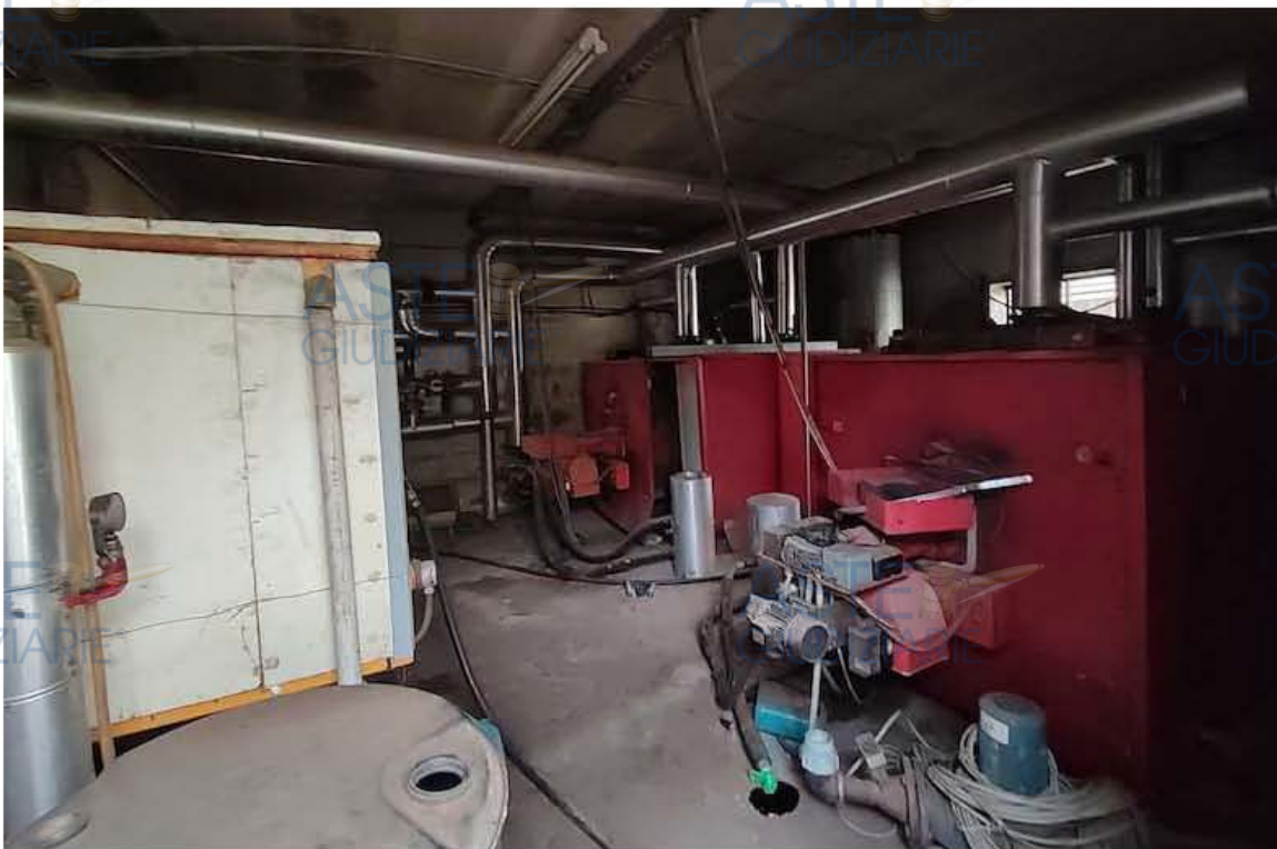
Foto 34 – Lotto 2 – Interno locale caldaia C
