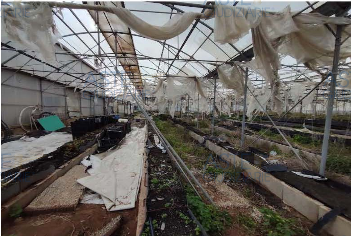
Foto 30 – Lotto 2 – Interno serra 1 in stato di abbandono
