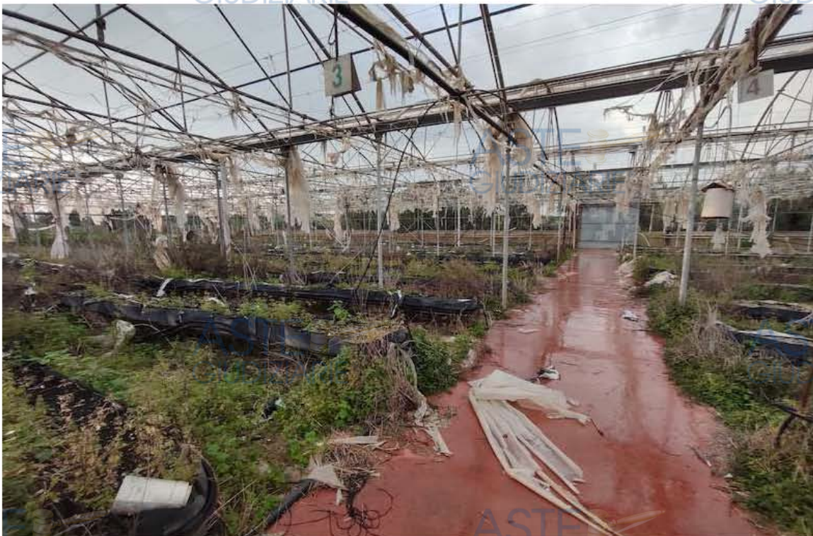
Foto 63 – Lotto 2 – Interno serra 2 in stato di abbandono
