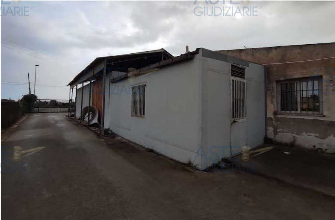
Foto 26 – Lotto 2 – Locale caldaia A privo di regolarità edilizia e catastale – vista esterna
