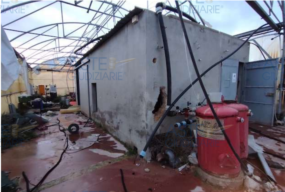
Foto 21 – Lotto 3 – Deposito dismesso all'interno della serra
