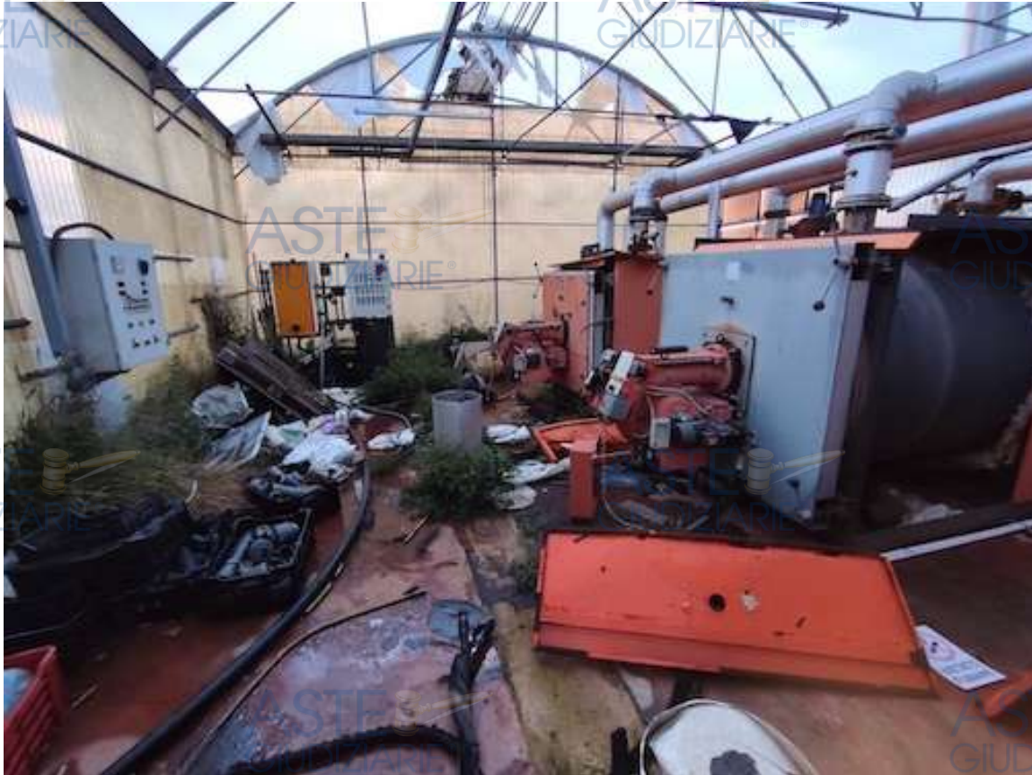
Foto 23 – Lotto 3 – Impianti irrigui e caldaie per il riscaldamento dismessi e vandalizzati
