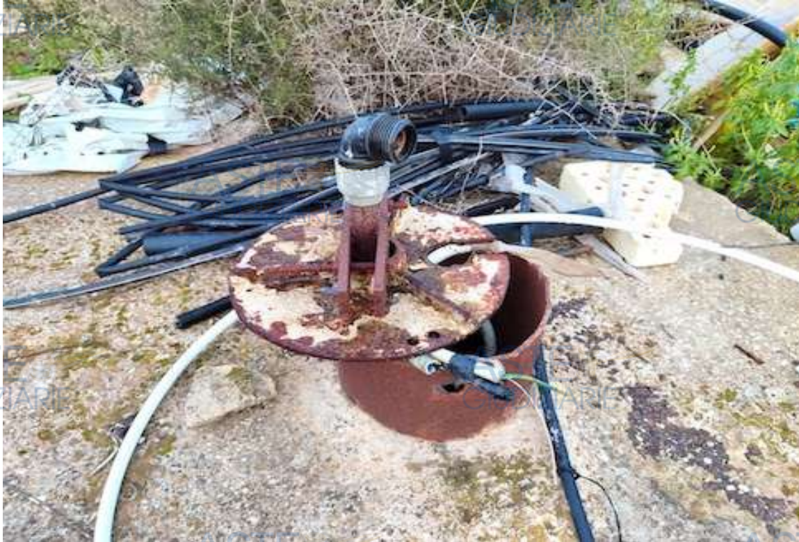
Foto 13 – Lotto 3 – Pozzo trivellato dismesso
