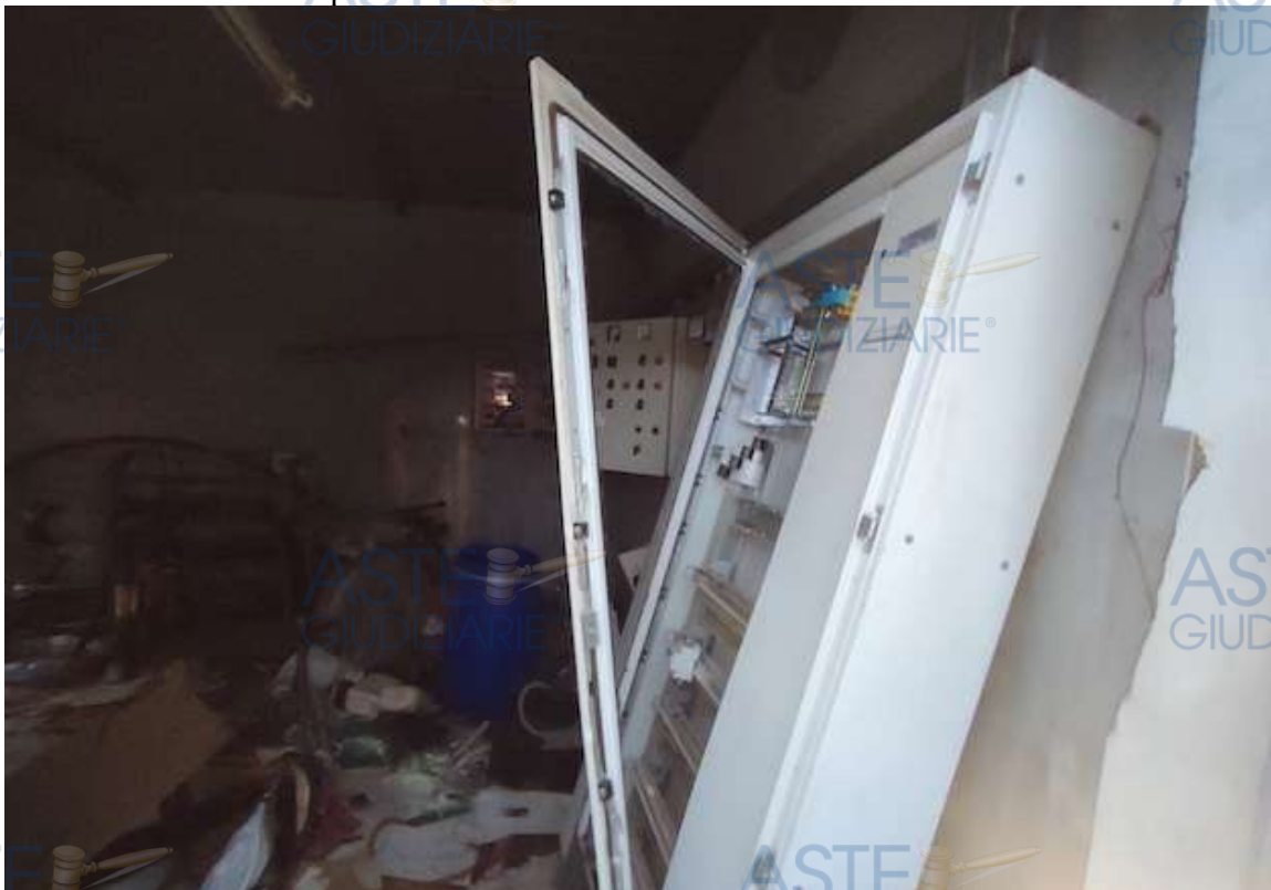
Foto 18 – Lotto 3 – Vista interna del deposito vandalizzato
