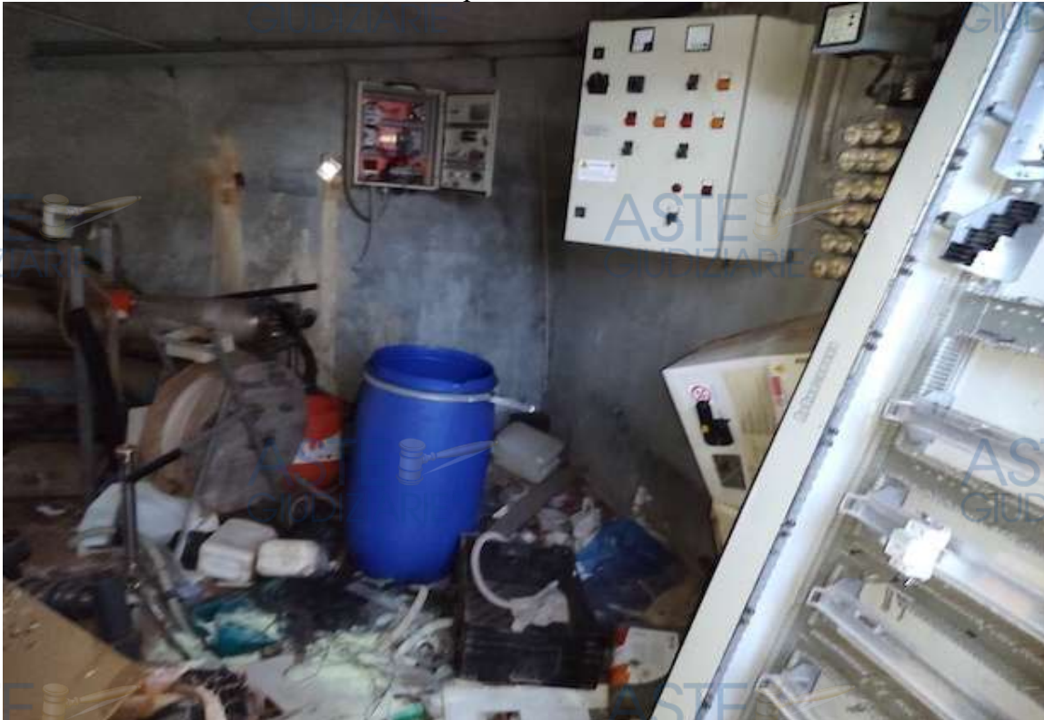
Foto 20 – Lotto – Vista interna del deposito vandalizzato
