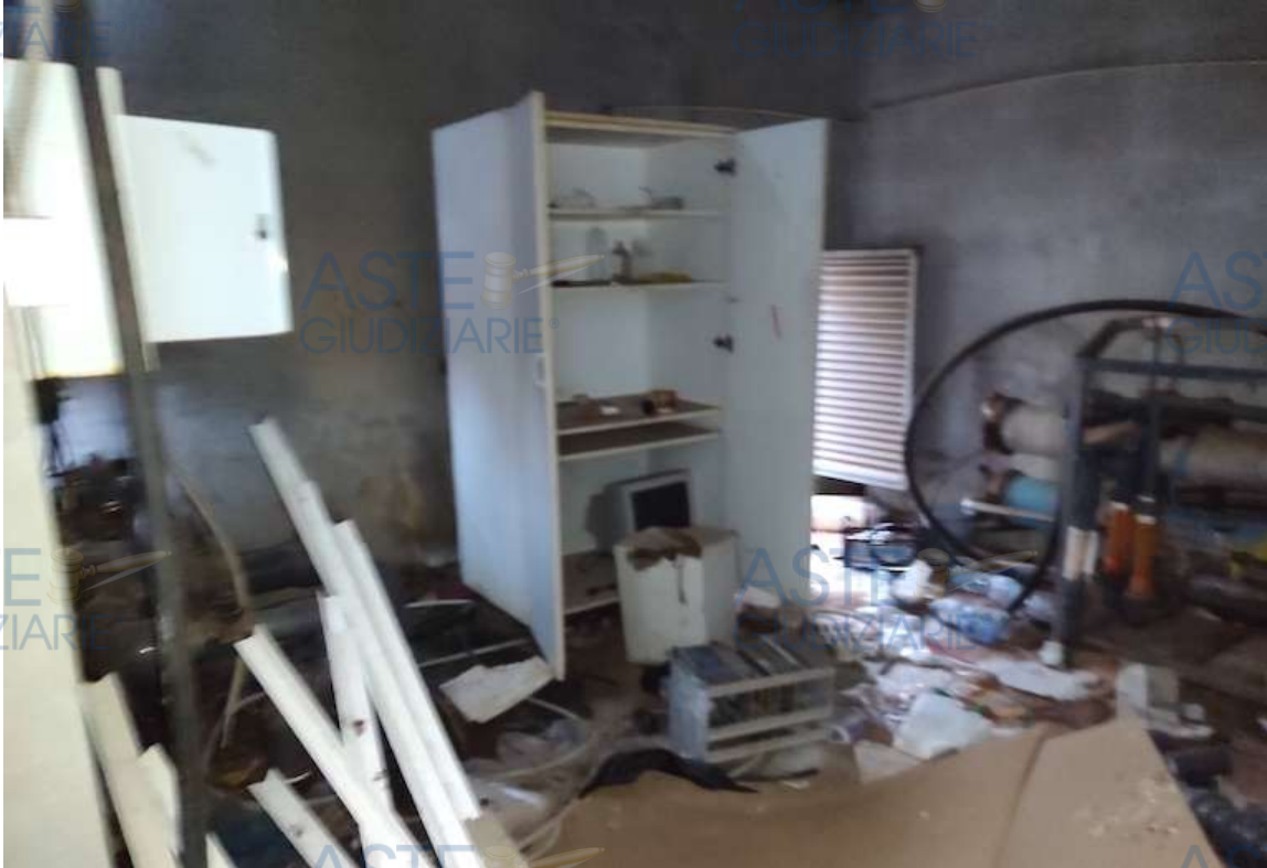
Foto 19 – Lotto 3 – Vista interna del deposito vandalizzato
