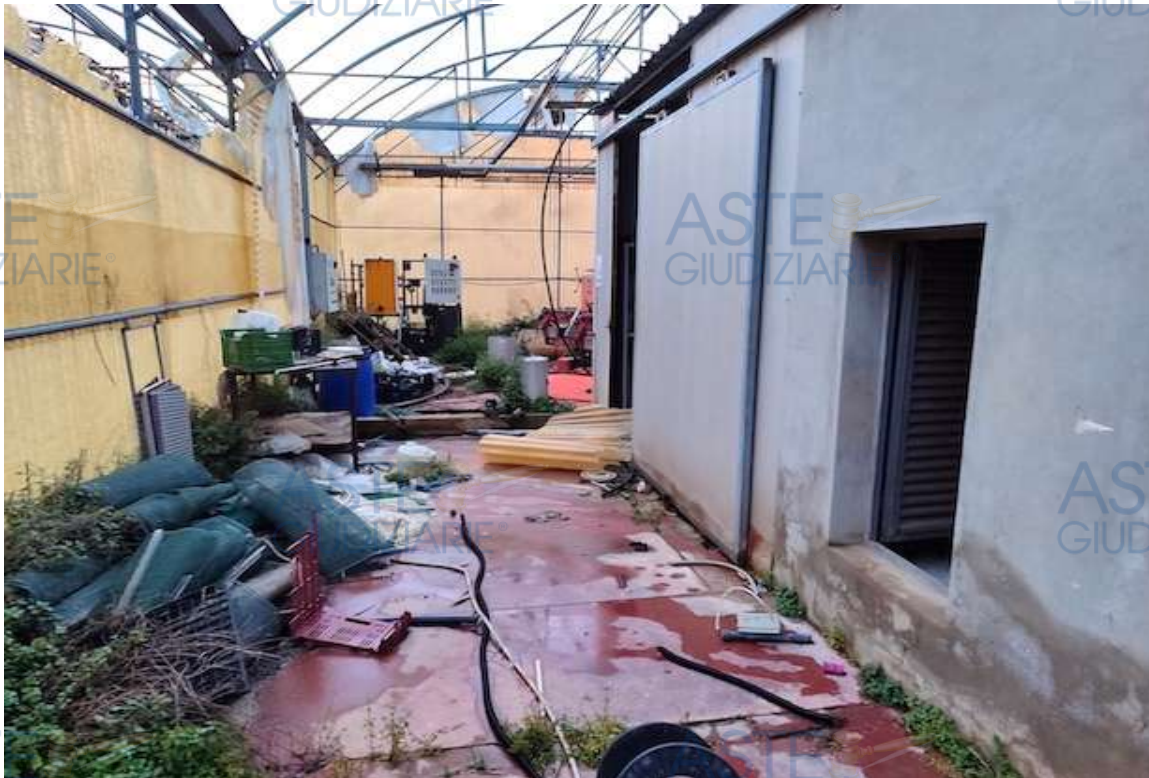
Foto 22 – Lotto 3 – Deposito dismesso all'interno della serra
