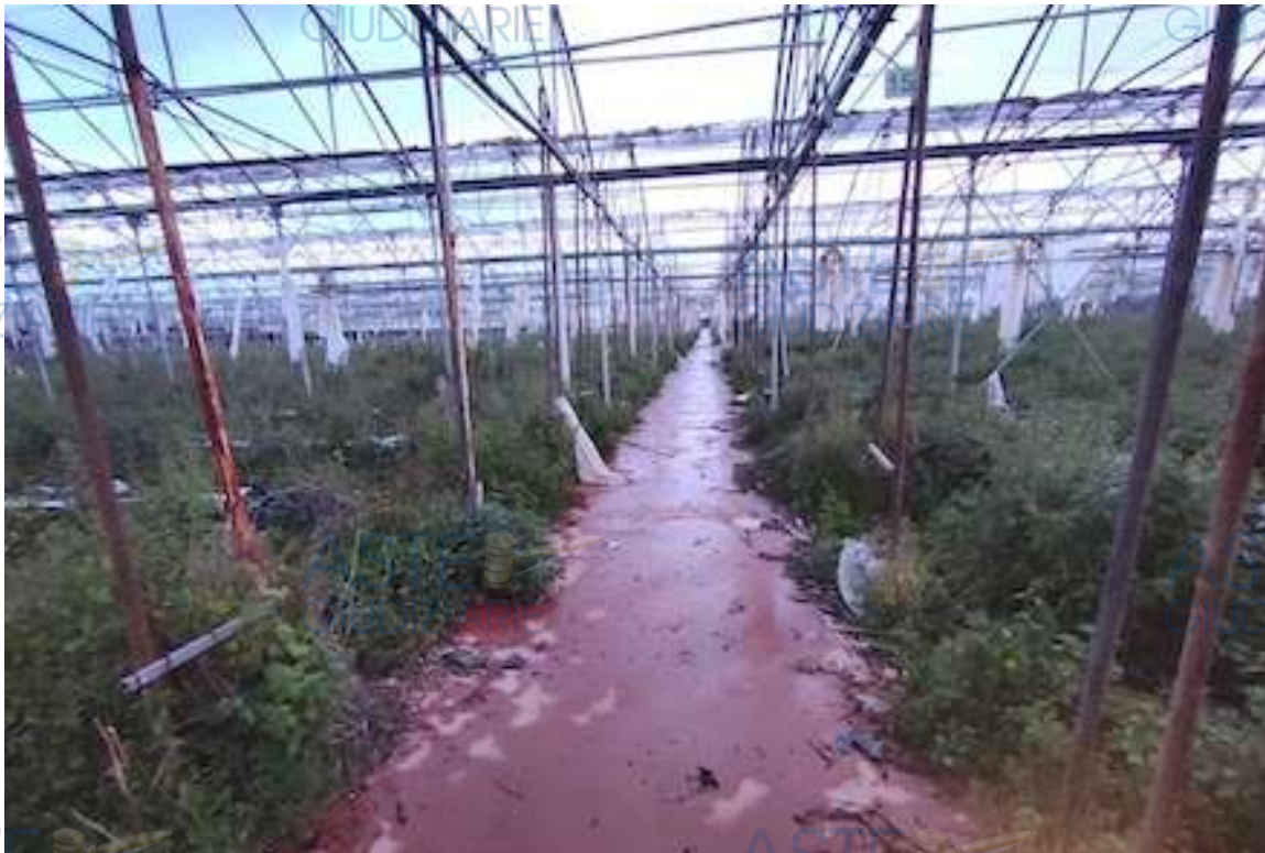
Foto 16 – Lotto 3 – Interno serra in stato di abbandono
