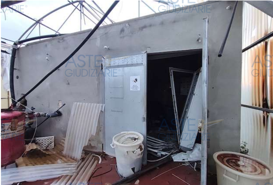
Foto 17 – Lotto 3 – Deposito vandalizzato all'interno della serra
