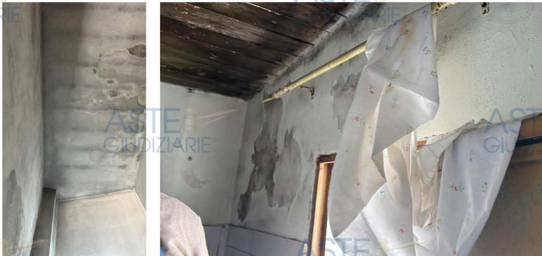
Figura n. 35 e 36 : Macchie di umidità e fenomeni di infiltrazione di acqua (3° Piano)
