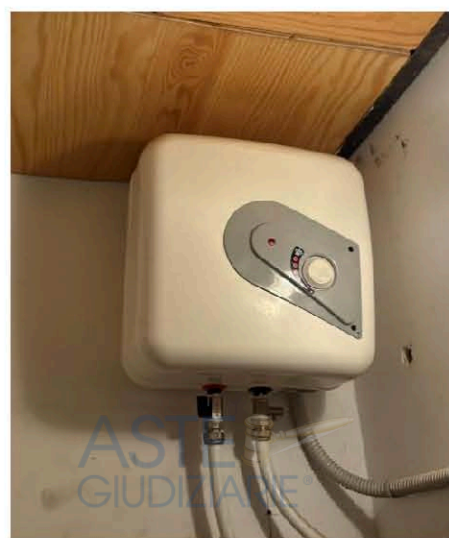
Figura n. 30 : Scaldabagno Piano Terra
