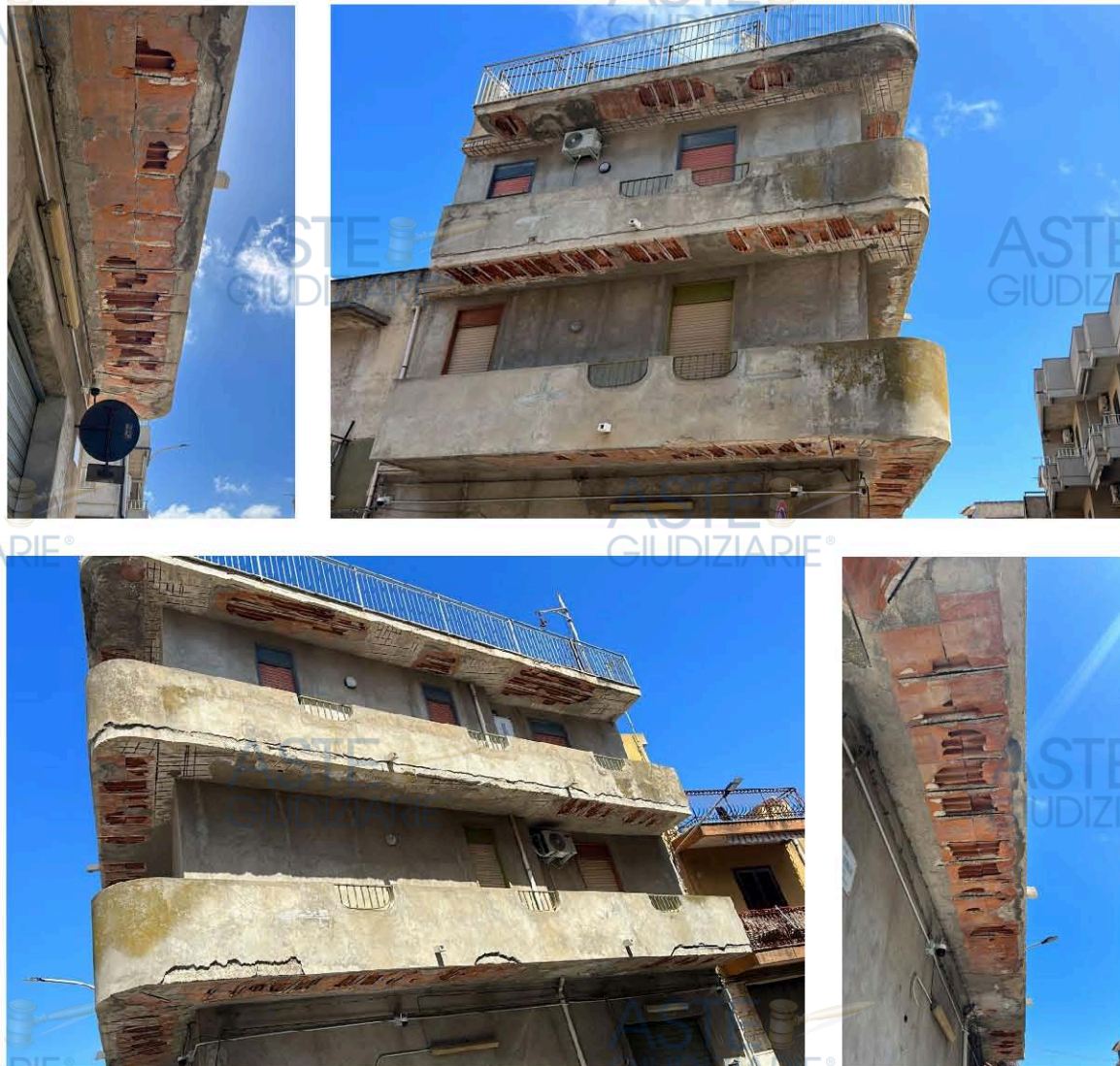
Figura n. 41, 42, 43 e 44 : Condizioni sottobalconi.
