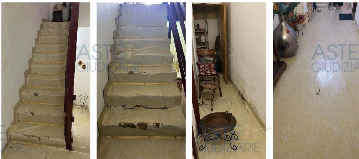
Figura n. 37, 38, 39 e 40 : Pavimentazione pianerottoli e rampe scale costituita da fogli di PVC.
