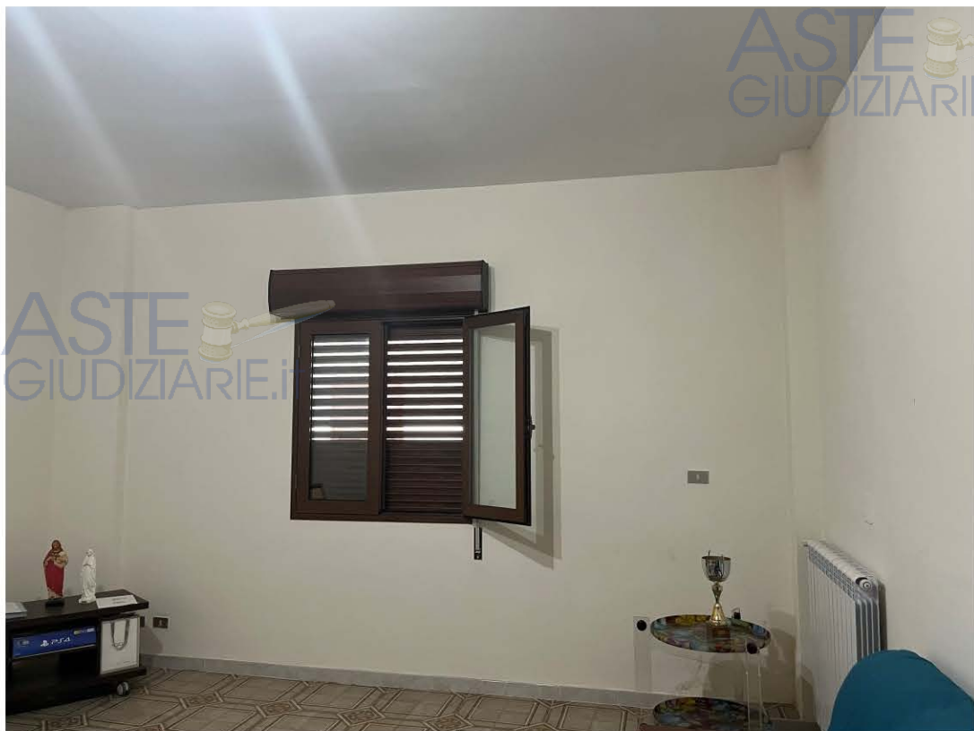
Foto n. 2 – soggiorno a piano terra con particolare della finestra difforme rispetto agli elaborati allegati alla Concessione Edilizia in sanatoria
