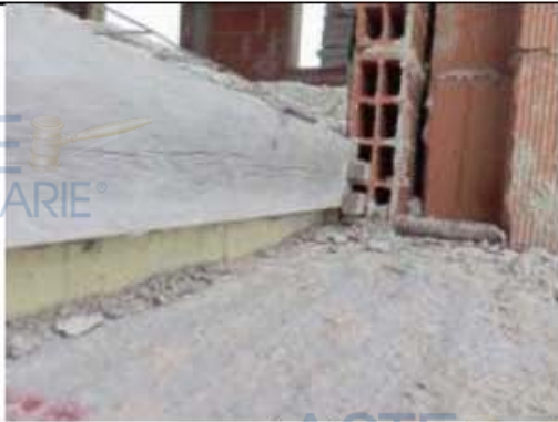
Foto 27: materiale isolante termico
