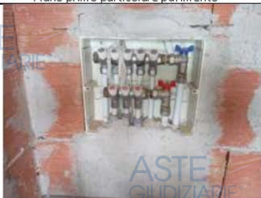
Piano primo particolare impianto acqua
