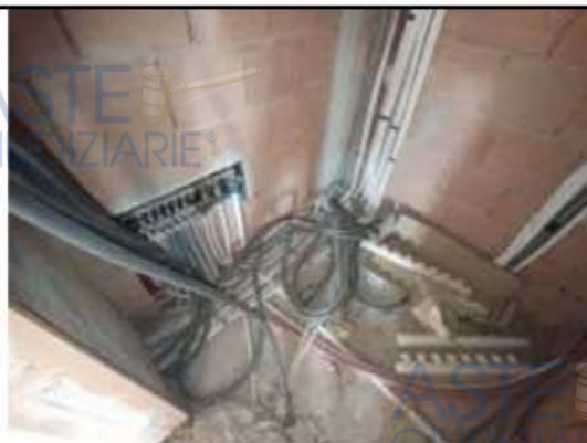
Seminterrato particolare impiantistica
