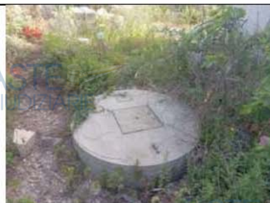
Pozzo nero a tenuta stagna lato Ovest
