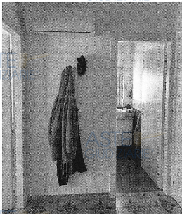
Foto antibagno Unità 3 (sx ingresso – dx infiltrazioni)
