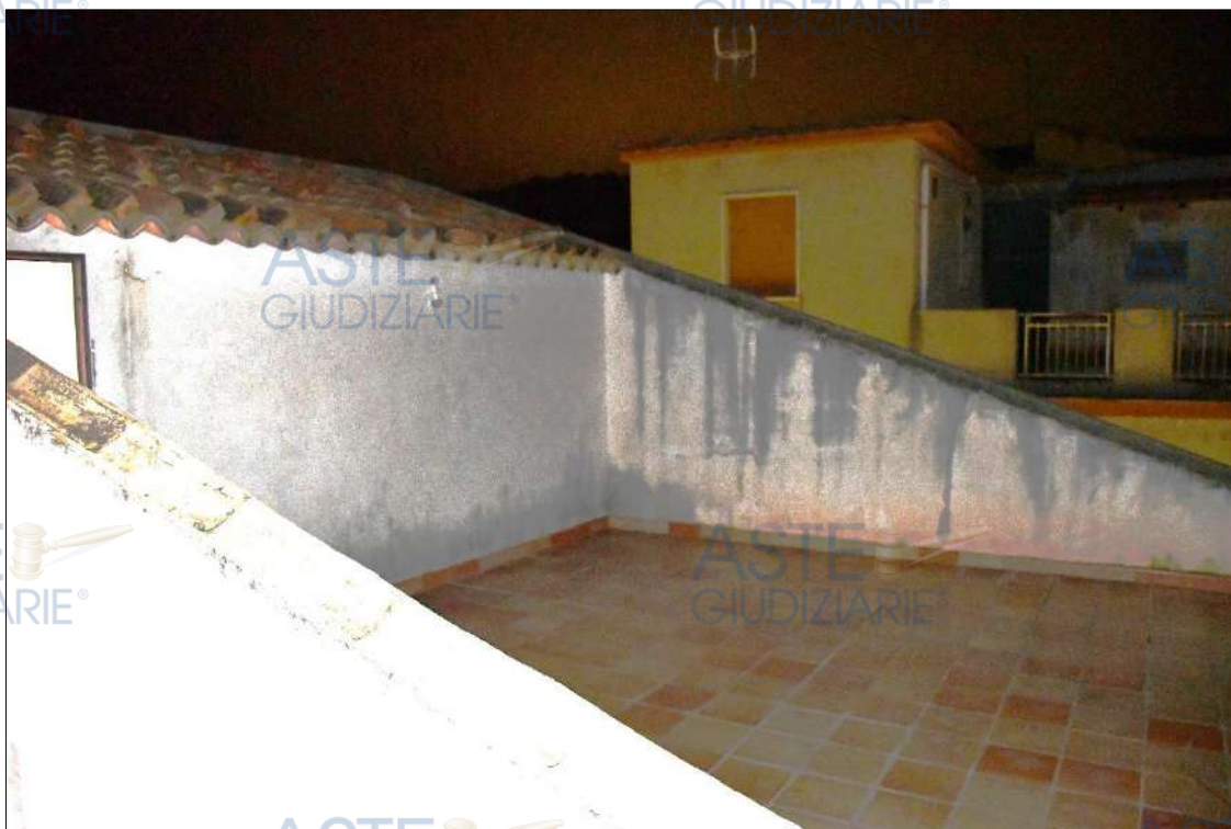
Foto – Tetto da riportare allo stato di progetto.
