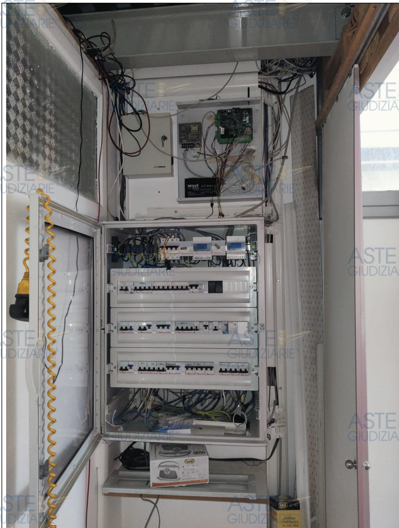
Quadro elettrico esistente
