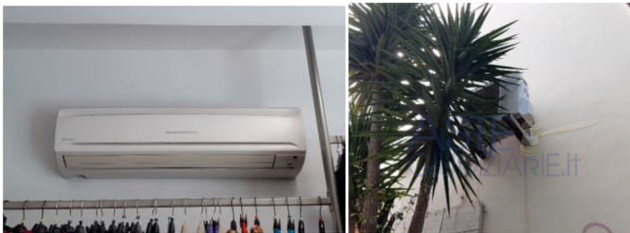
Figura 7: Inverter DAIKIN rilevato in sede di sopralluogo
