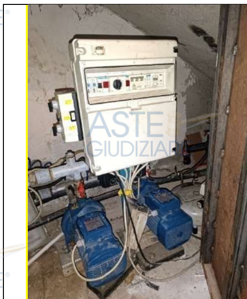
Foto 26. Particolare del motore che alimenta il sistema autoclave condominiale
