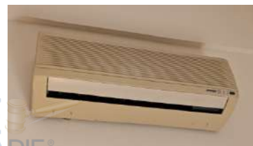
Foto 20. Particolare degli split interni dei sistemi di condizionamento
