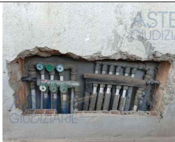
Foto 17. Particolare del collettore (centralina) dell'acqua che serve i bagni dell'abitazione
