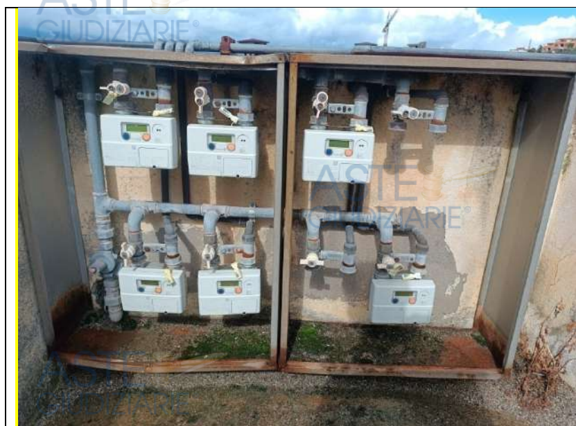
Foto 25. Particolare dei contatori metano posti all'esterno del fabbricato, sulla terrazza
