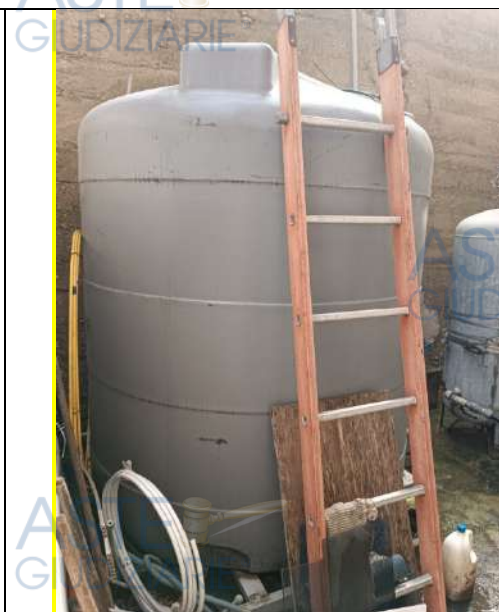
Foto 27. Particolare della cisterna dell'autoclave condominiale
