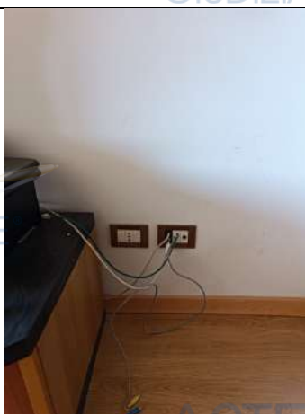
Foto 14. Particolare della tipologia di prese di corrente elettrica presenti nell'appartamento
