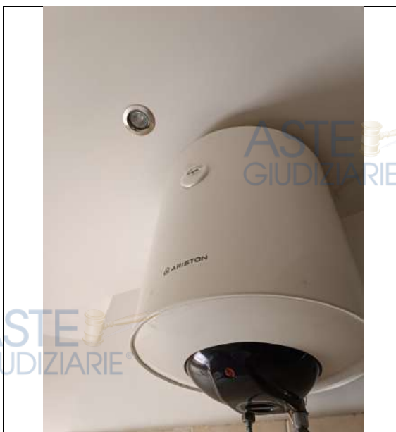
Foto 22. Vista del presente scaldino per l'acqua calda sanitaria posto nel Bagno 1
