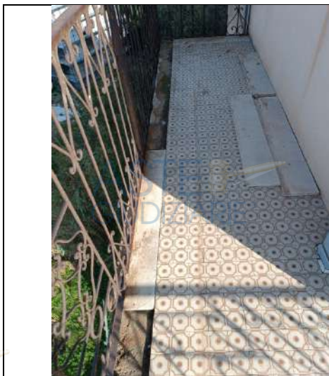
Foto 67. Particolare dei marmi del pavimento balcone divelti
