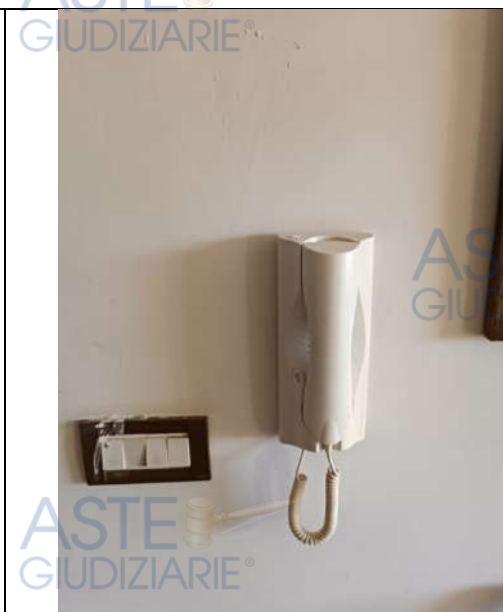
Foto 24. Particolare del sistema citofonico
