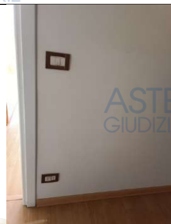
Foto 15. Particolare della tipologia di prese ed interruttori di corrente elettrica presenti nell'appartamento
