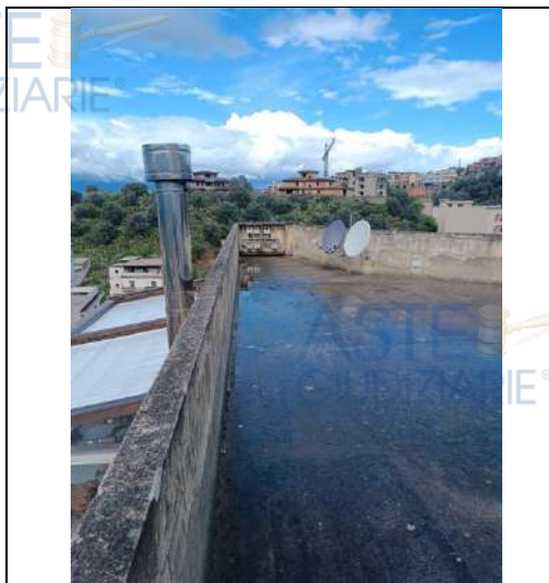
Foto 69. Particolare del parapetto della terrazza, rustico e con assenza del copri-muro
