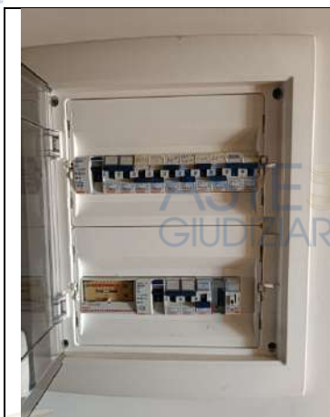
Foto 13. Particolare del quadro elettrico generale dell'impianto elettrico dell'appartamento
