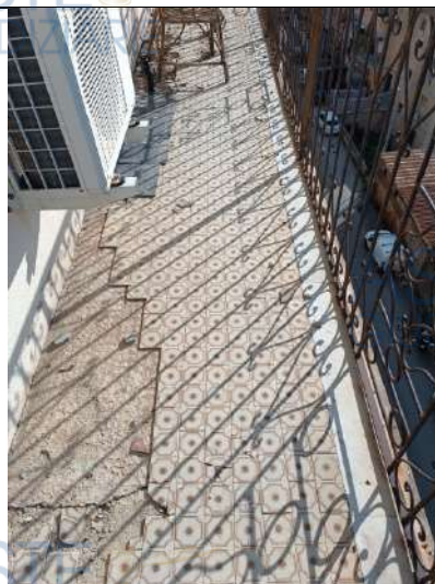
Foto 68. Particolare dei pavimenti del balcone divelti
