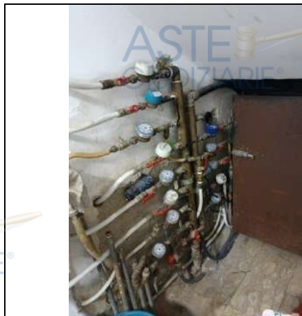
Foto 16. Particolare dei contatori dell'acqua che servono i vari appartamenti del fabbricato, posti nel vano sottoscala, al piano terra
