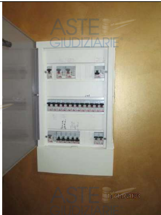
Foto 13. Particolare del quadro elettrico che serve l'appartamento posto al piano primo, sub 5
