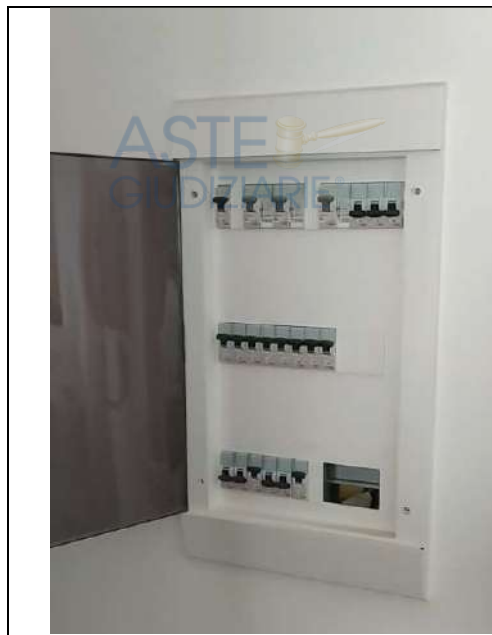
Foto 93. Particolare del quadro elettrico, installato all'interno dell'immobile, in prossimità dell'ingresso, al piano secondo
