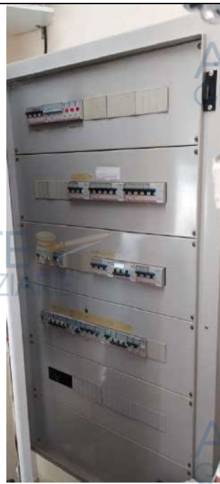
Foto 14. Particolare del quadro elettrico che serve il negozio posto al piano terra, sub 4
