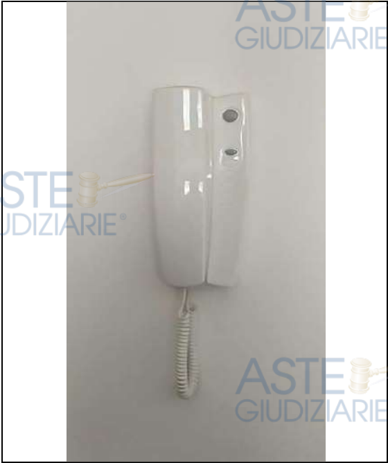
Foto 92. Particolare dell'impianto citofonico
