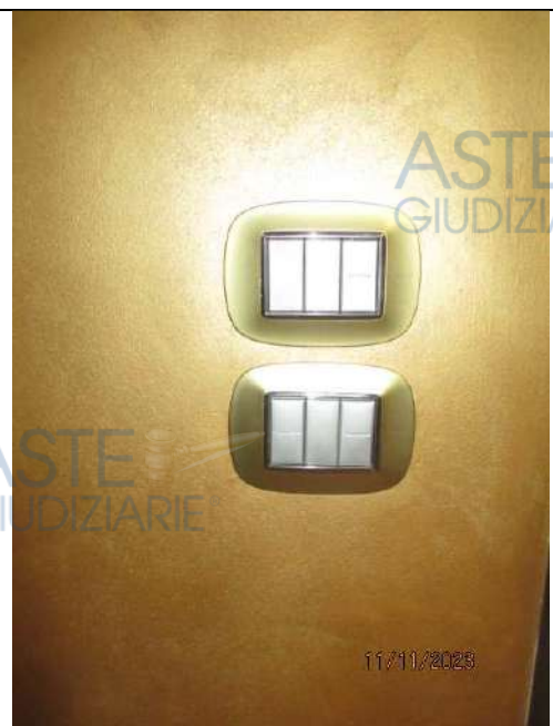
Foto 68. Particolare della tipologia di interruttori elettrici installati all'interno dell'immobile
