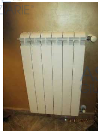
Foto 72. Particolare dei termosifoni installati nei diversi ambienti dell'immobile
