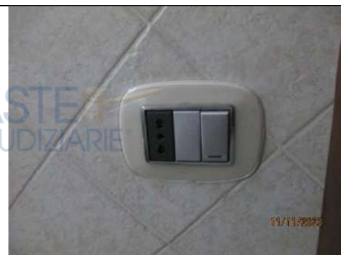
Foto 70. Particolare delle prese elettriche installate all'interno dei bagni dell'immobile
