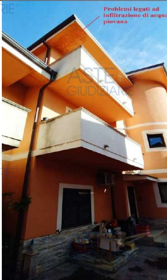
Foto 102. Particolare dei problemi legati ad infiltrazione di acqua piovana nell'intradosso del solaio di copertura, concentrati in prossimità del pluviale
