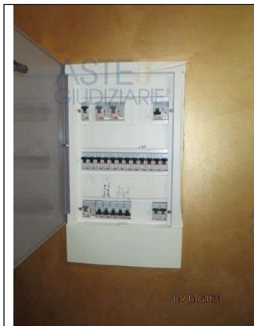
Foto 67. Particolare del quadro elettrico, installato all'interno dell'immobile, in prossimità dell'ingresso, al piano primo
