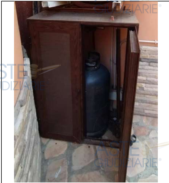
Foto 35. Particolare del sistema dell'impianto idrico-sanitario, installato all'esterno dell'immobile, in prossimità dell'ingresso, al piano terra
