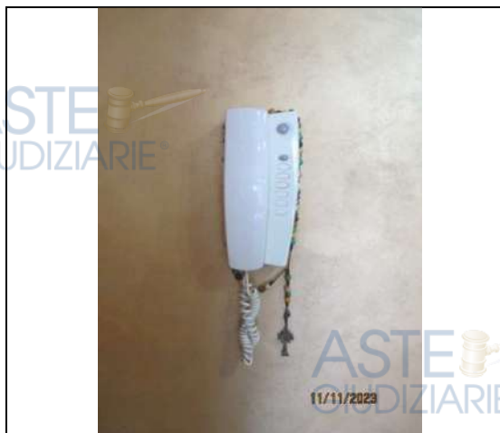
Foto 66. Particolare dell'impianto citofonico
