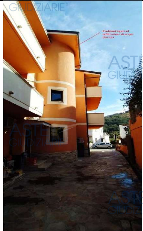
Foto 103. Particolare dei problemi legati ad infiltrazione di acqua piovana nell'intradosso del solaio di copertura, concentrati in prossimità del canale di gronda
