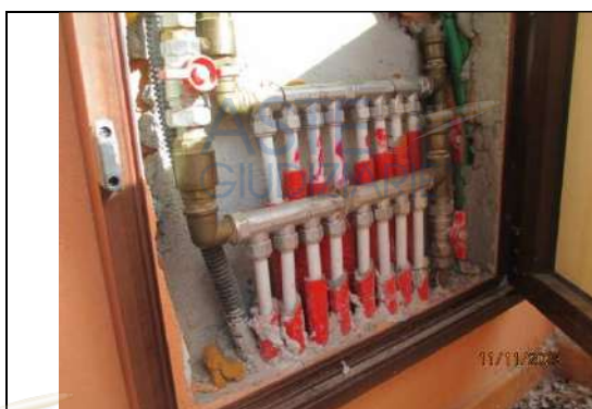
Foto 73. Particolare del quadro comandi idrico-sanitario
