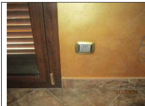
Foto 69. Particolare delle prese elettriche installate all'interno dell'immobile
