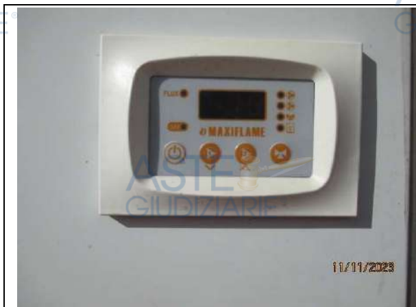
Foto 71. Particolare del sistema di comando dell'impianto di riscaldamento
