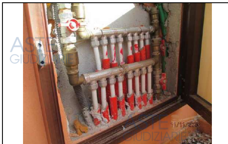
Foto 15. Particolare di uno dei quadri contatori dell'acqua delle diverse utenze dei beni pignorati
