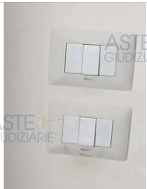
Foto 94. Particolare della tipologia di interruttori elettrici installati all'interno dell'immobile
