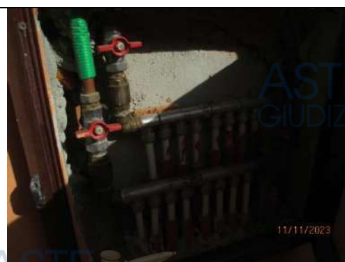
Foto 74. Particolare del quadro comandi idrico-sanitario
