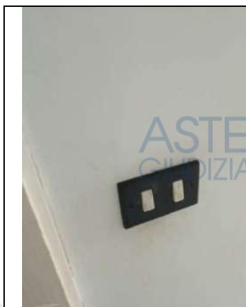
Foto 12. Particolare della tipologia di interruttori dell'impianto elettrico al piano Terra
