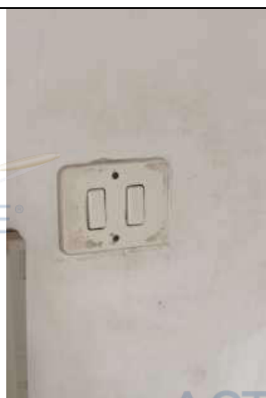
Foto 13. Particolare della tipologia di prese dell'impianto elettrico al piano Secondo
