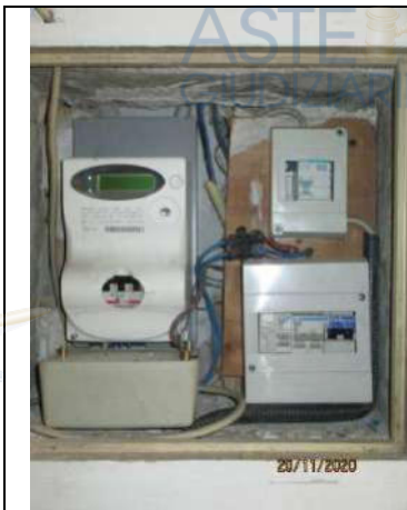
Foto 9. Particolare del contatore presente all'interno dell'unità abitativa, oggetto di pignoramento, al piano Terra
