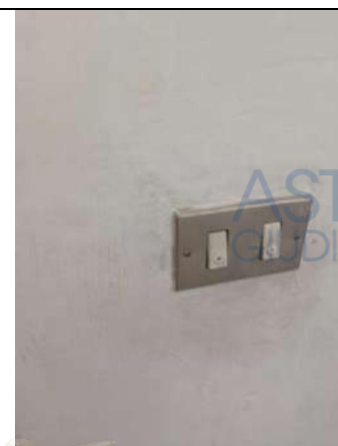
Foto 14. Particolare della tipologia di prese dell'impianto elettrico al piano Terzo
