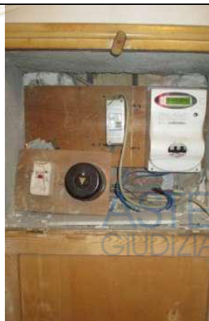
Foto 10. Particolare del contatore presente all'interno dell'unità abitativa, oggetto di pignoramento, al piano Secondo
