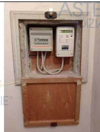
Foto 11. Particolare del contatore presente all'interno dell'unità abitativa, oggetto di pignoramento, al piano Terzo
