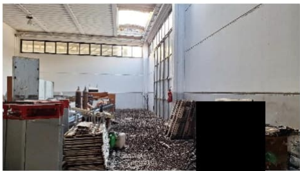
Copertura divelta: deposito capannone B
