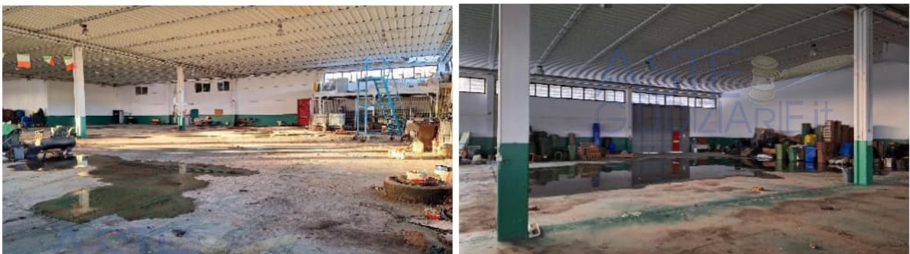
Infiltrazioni dal tetto capannone B
