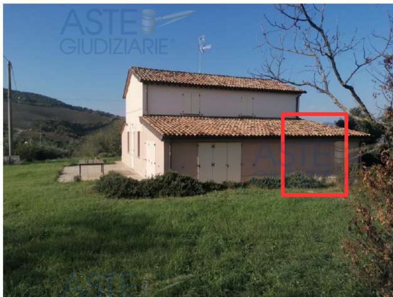
1 Mancata realizzazione di apertura su locale cucina-soggiorno
