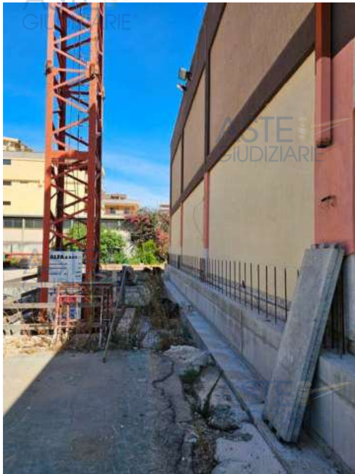
Foto n. 19 – Gru a torre ALFA Mod. A662 CITY
