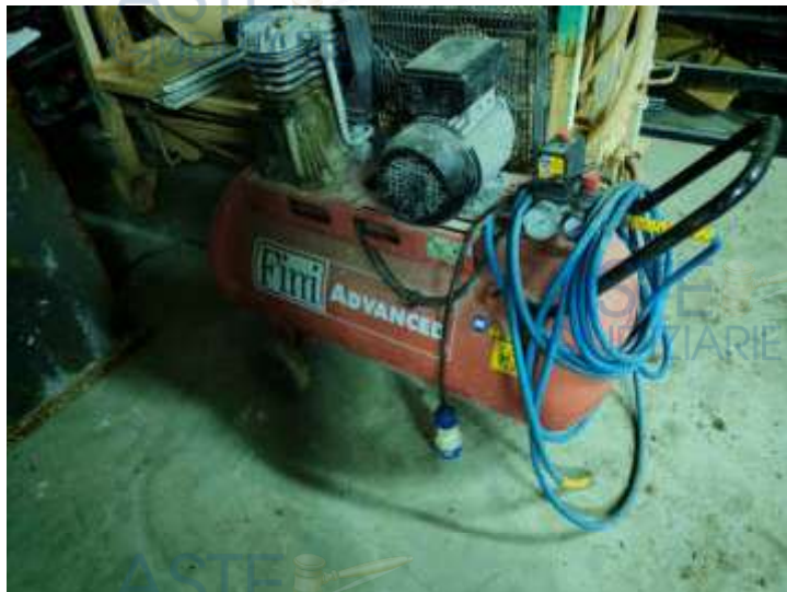
Foto n. 50 – compressori Advance Fini
