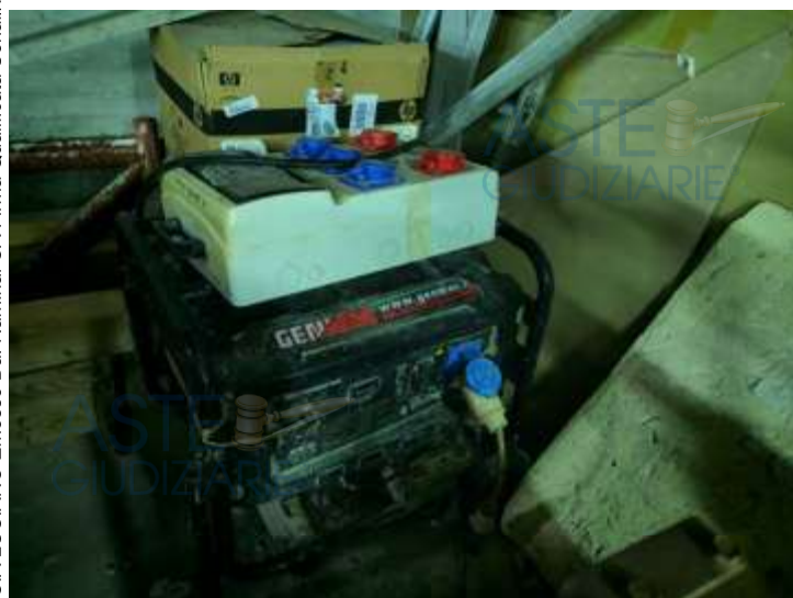
Foto n. 53 – Utensili vari – Generatore
