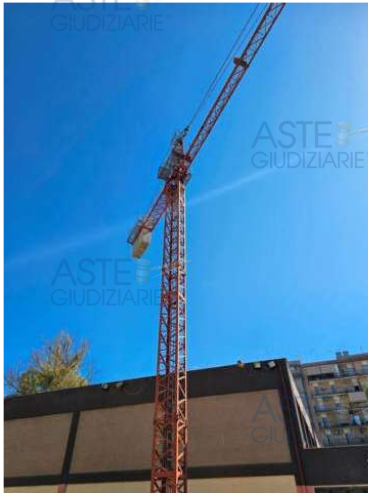
Foto n. 20 – Gru a torre ALFA Mod. A662 CITY
