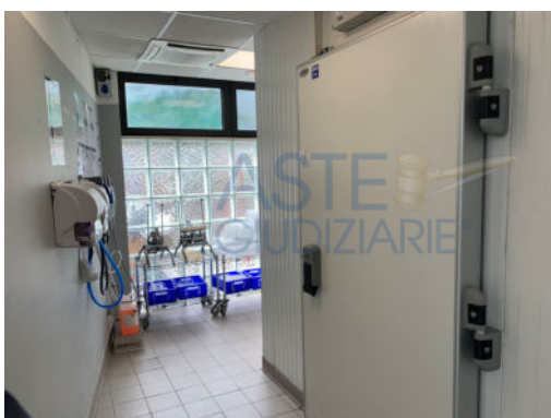
Figura 167 - Autogrill: Celle frigorifere
