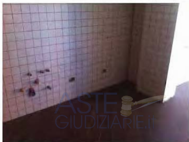
Vista cucina dettaglio impianti
